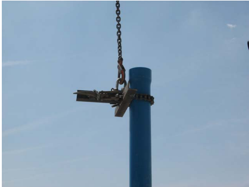
Detalle: Tubería elevada
