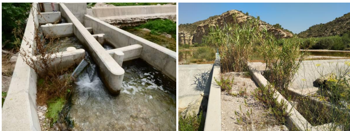
Figura 38. Vista de las escalas de peces de artesas sucesivas del azud de la Fábrica (izq.) y del azud del Matarraña (dch.) en las que es necesario extraer las gravas del interior de las artesas y un tramex que obstruye un vertedero para mejorar su continuidad.
