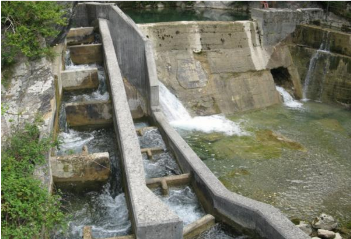
Figura 3. Escala de artesas sucesivas emplazada en la margen derecha del azud de la CH de Isaba.
