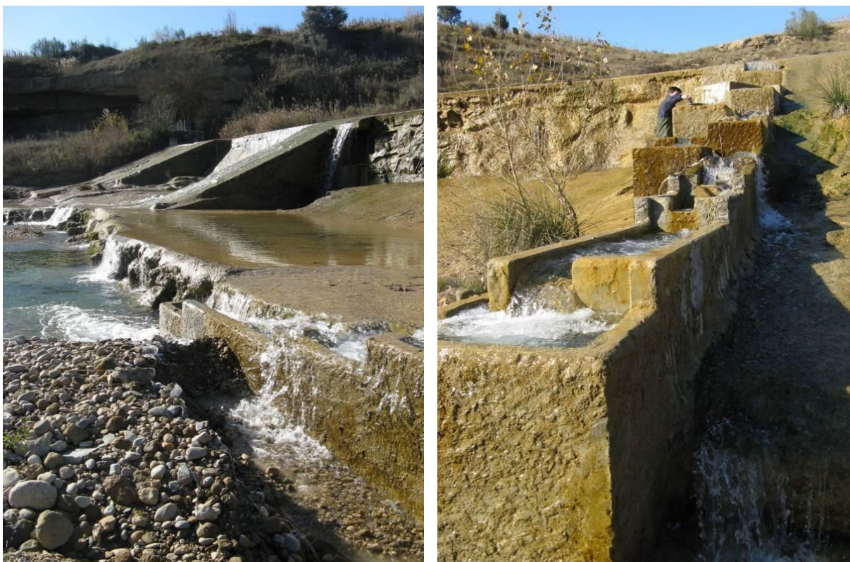
Figura 6. Vistas de la escala de artesas en la que se aprecia el vertido libre entre algunas de las artesas, la ausencia de vertido en otras y el incorrecto sobredimensionamiento de los muros laterales de la escala.
