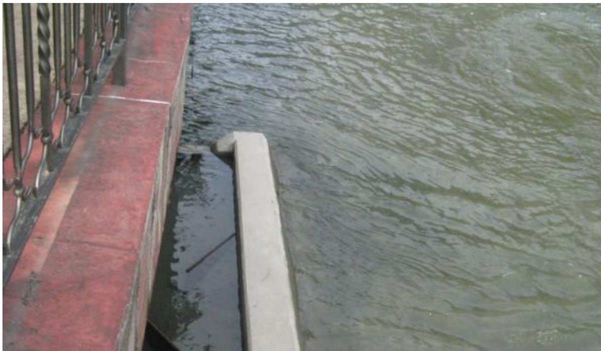
Figura 11. Detalle de la entrada para los peces al tercer paso, ésta se encuentra a nivel del río, pero no dispone caudal de llamada para atraer a los peces.
