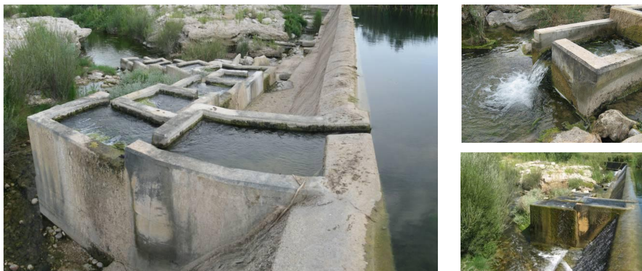
Figura 50. Vista de la escala de artesas sucesivas en vertido libre del azud de Vilanova. Como puede observarse en la fotografía de arriba a la derecha la entrada de la escala para los peces se encuentra descolgada de la lámina de aguas abajo. En la foto de abajo a la derecha se observa que el paso no está sobredimensionado por lo que cuando circulan caudales que rebosan por el azud se desborda.
