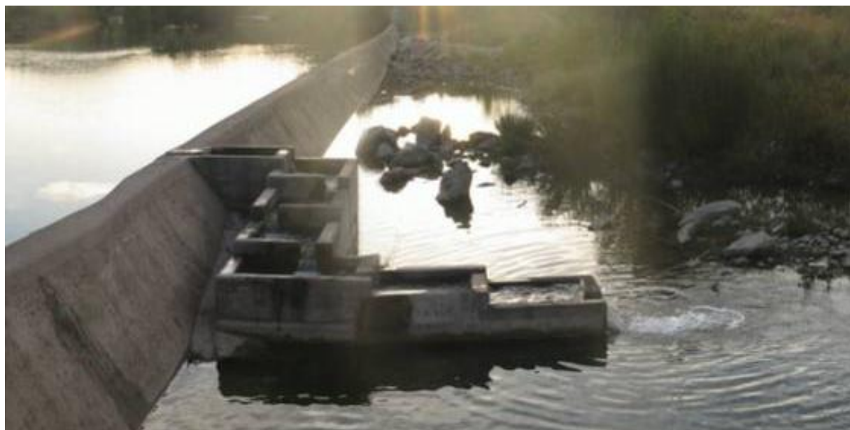
Figura 53. Azud y la escala de artesas sucesivas en vertido libre de la acequia de la C.R. de la Huerta Alta de Maella. El vertido de la última artesa (entrada de los peces al paso) se encuentra un poco descolgado de la lámina de aguas abajo del azud, hecho que dificulta la entrada de los peces al paso.
