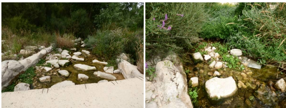
Figura 37. Vista de la rampa construida para permeabilizar un badén en Valderrobres la cual se encuentra parcialmente colmatada de sedimentos en los que se ha desarrollado vegetación que merma el grado de permeabilidad del paso.
