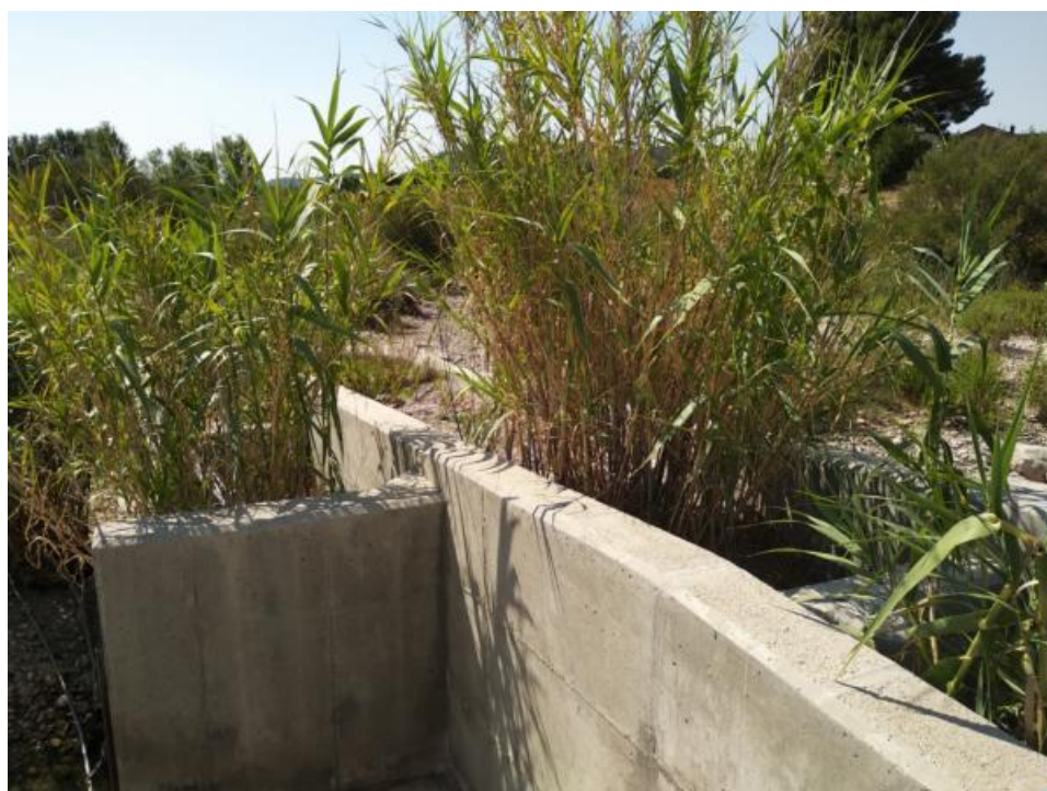
Figura 56. Vista de las artesas de la escala de peces del azud del Matarraña en las que se ha desarrollado vegetación en su interior
