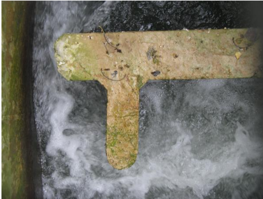
Figura 54. Detalle de un tabique interior del paso del Azud del Molino de Labeaga. El deflector está muy próximo al vertedero. Éste debía encontrarse a la misma distancia de la rasante del vertedero que el ancho del mismo. (aproximadamente 20 cm).
