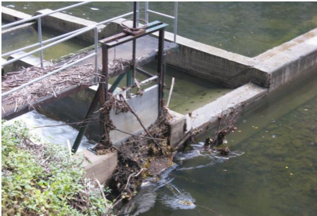
Figura 5. Entrada de caudal al paso de la toma de aguas de Vitoria. Este tipo de vertederos para las entradas de caudal no son los más adecuados, ya que en periodos de caudales bajos no entra caudal en el paso.
