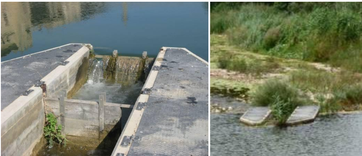
Figura 44. Vista de la entrada de caudal durante un periodo de caudales altos. Al no estar sobredimensionado el primer tabique, durante periodos de incremento de caudal el agua rebasa el primer tabique entrando al paso. En la imagen de la derecha, tomada en julio de 2017, se aprecia que la entrada de caudal al paso está obstruida por vegetación.
