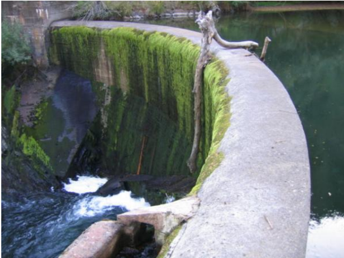
Figura 26. Azud de la CH de la Retorna. En el primer plano se aprecia la artesa de entrada de caudal. Este paso finaliza en el centro del azud y presenta una elevada pendiente, ya que salva los 8 m de desnivel del obstáculo en muy poca distancia.
