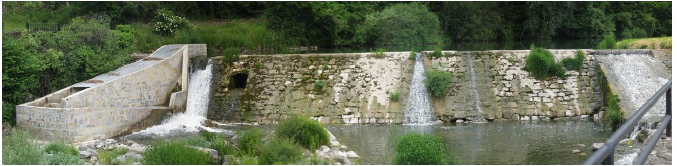
Figura 79. Escala de peces del azud de la CH. de Oronz, emplazada en el costado de la margen derecha
