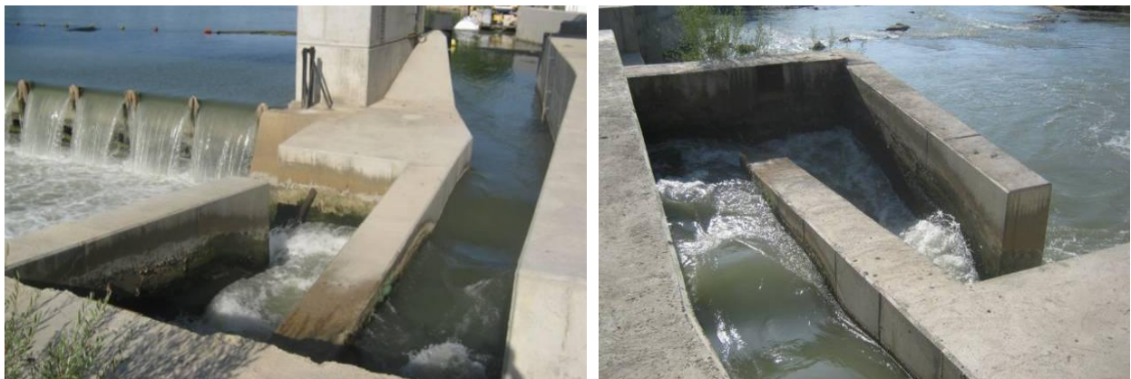
Figura 88. Interior de la escala, el caudal circula por encima de los tabiques intermedios de las artesas, creándose una lámina en vertido libre que presenta una velocidad muy elevada para permitir que los peces puedan remontar el paso.
