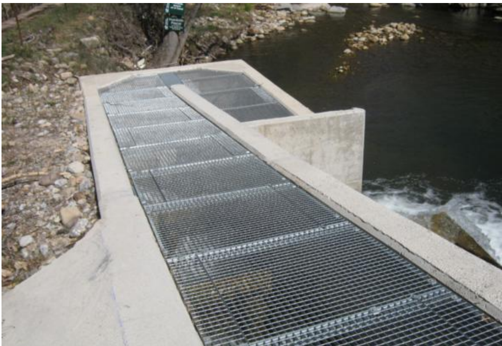
Figura 20. Tramex instalado en la escala de peces para evitar accidentes y furtivismo.
