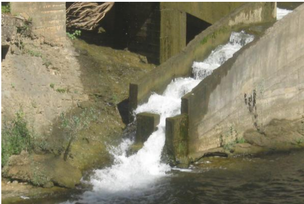
Figura 58. Entrada al paso para los peces del azud de la CH de Alós, como se observa se encuentra muy descolgada de la lámina del río de aguas del azud. Otro aspecto negativo del paso es el vertido libre entre artesas y el elevado salto que presentan.
