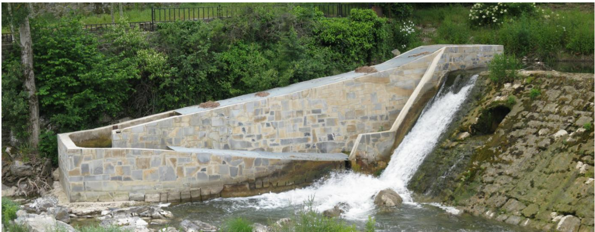
Figura 80. Escala de peces del azud de la CH. de Oronz donde se observa el caudal de llamada concentrando en la entrada del paso. La poza de entrada al paso carece de calado suficiente para permitir la entrada de los peces a la escala.
