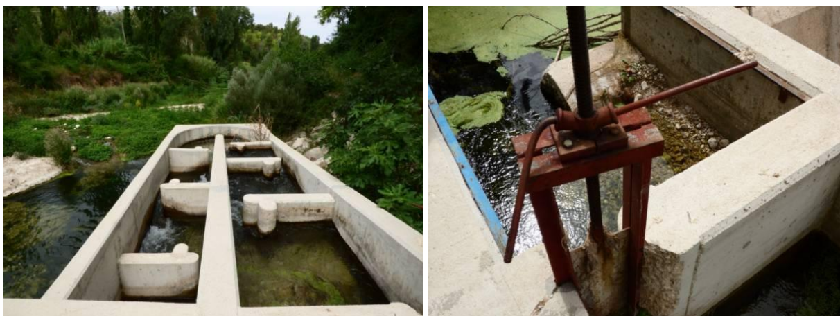
Figura 48. Vista de la escala de artesas sucesivas. En uno de los vertederos se ha atrancado el tramex para maniobrar la compuerta obstruyéndolo e impidiendo que puedan remontar el paso los peces. Además algunas artesas del paso se encuentran colmatadas desde la crecida de marzo de 2015. A la derecha se presenta la compuerta para la impermeabilización del paso la cual se encuentra dañada desde la citada crecida
