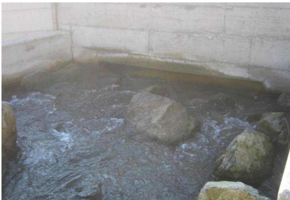
Figura 67. Entrada de caudal a la rampa de bloques de perturbación de la CH de Buicio.
