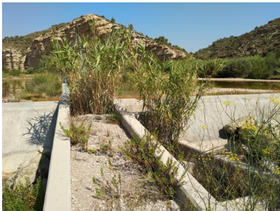
Figura 57. Vista de la primera parte de la escala del azud del Matarraña, junio de 2018, la cual se encuentra totalmente colmatada
