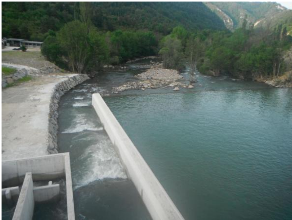
Figura 67. Vista del canal de entrada al paso desde aguas abajo del colchón amortiguador del azud de la presa de cola de Itoiz
