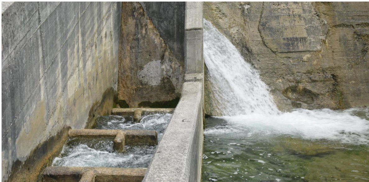
Figura 4. Entrada del paso del azud de la CH. de Isaba donde se aprecia como el caudal derivado en el rebaje del azud incrementa el efecto llamada
