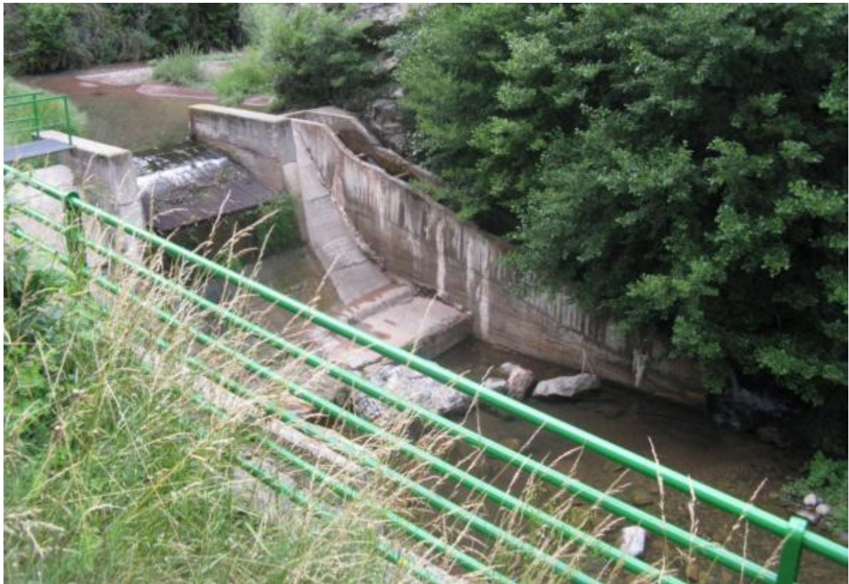
Figura 53. Azud de la CH Castellas. La escala de artesas sucesivas en vertido libre se localiza en la margen izquierda del azud.
