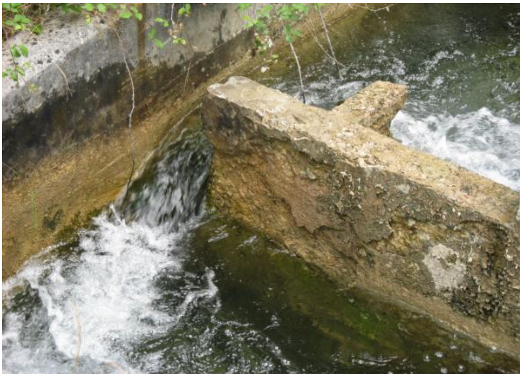
Figura 6. Detalle de un vertido semisumergido entre dos artesas y de un tabique interior del paso donde se aprecia el avanzado grado de deterioro
