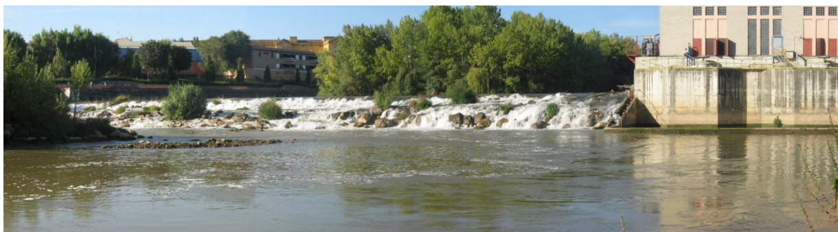
Figura 75. Azud de la CH de Logroño. El paso se localiza en el costado de la margen izquierda, próximo a la zona de desagüe de las turbinas. El emplazamiento del paso es el correcto, no obstante las dimensiones del paso y la falta de mantenimiento del mismo hacen que su grado de funcionamiento sea nulo.
