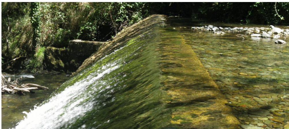
Figura 27. Azud de Brieva y paso de peces. Este paso se encuentra totalmente desconectado de la lámina del río de aguas abajo del azud, la entrada de caudal está muy colmatada y las artesas obstruidas por la vegetación.
