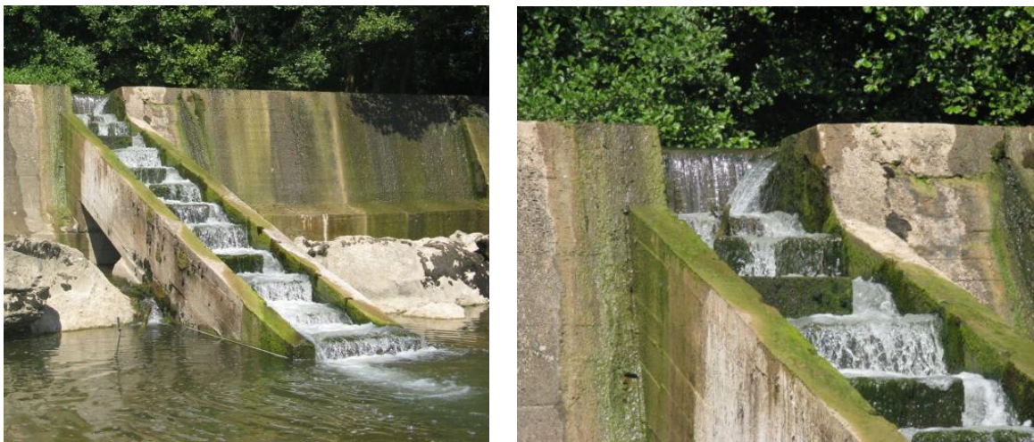
Figura 21. Escala del azud de la CH de Nofuentes funcionando con caudales más bajos que en la anterior caudales bajos. En la foto de la derecha se aprecia el gran salto que existe entre la última artesa y la lámina del río de aguas arriba del azud. En ese último tabique existen a vista partes del acero corrugado del armado de la estructura que pueden dañar al pez en el caso de que éste remontase este último salto.
