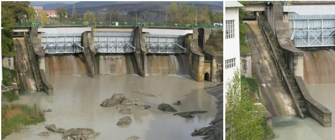
Figura 24. Vista de la escala de peces de artesas sucesivas de la presa de Sabiñánigo. Este paso presenta desniveles entre artesas muy elevados para que un pez pueda remontarlo con facilidad. Además, no circula caudal en el paso, encontrándose fuera de uso.
