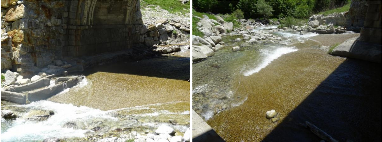
Figura 24. Vista del paso del puente de la N-420 cuya parte inicial está destruida (izquierda) y vista del mismo desde la margen izquierda
