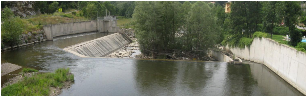
Figura 43. Azud de los Recursos Energéticos Locales, S.A (Salto de Cabiscol). El paso está emplazado correctamente en la margen derecha. Sin embargo, la entrada al mismo se encuentra muy alejada de la base del azud.
