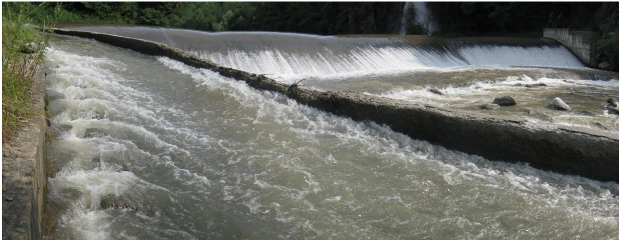
Figura 46. Azud de la Comunidad de Regantes de Sant Pere, el paso se localiza en el costado de la margen derecha junto al canal de descenso de piraguas
