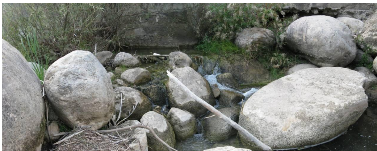
Figura 36. Vista de la entrada a la escala para los peces que se encuentra obstruida por bolos de grandes dimensiones impidiendo la entrada de los peces en el mismo.
