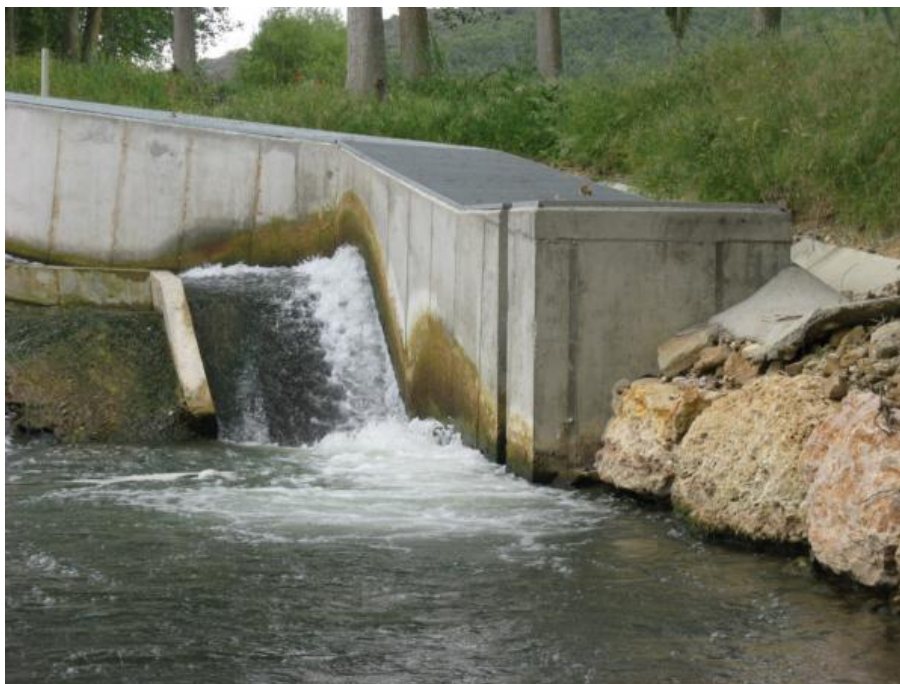
Figura 53. Entrada de la escala del Azud del Molino de Labeaga donde se aprecia que existe una llamada.
