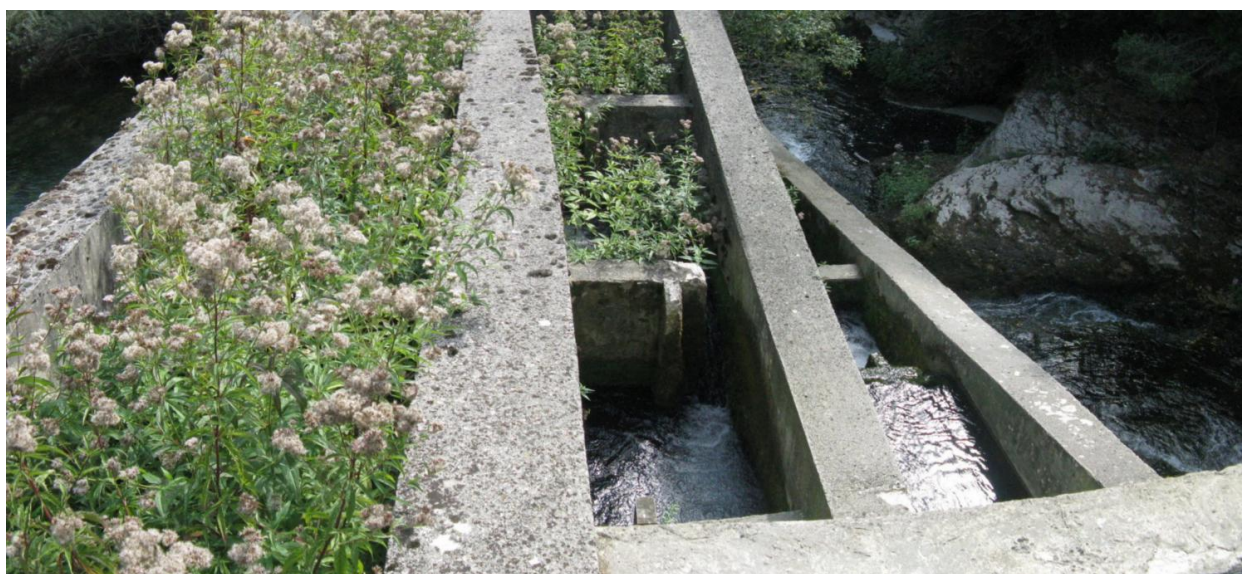
Figura 45. Paso nuevo de la presa de la piscifactoría de Zudaire. El escaso mantenimiento de la estructura ha favorecido la aparición de especies vegetales en el interior de las artesas. Los deflectores fueron construidos en el lado de aguas abajo del tabique, posteriormente se instalaron unos deflectores en el costado de aguas arriba.
