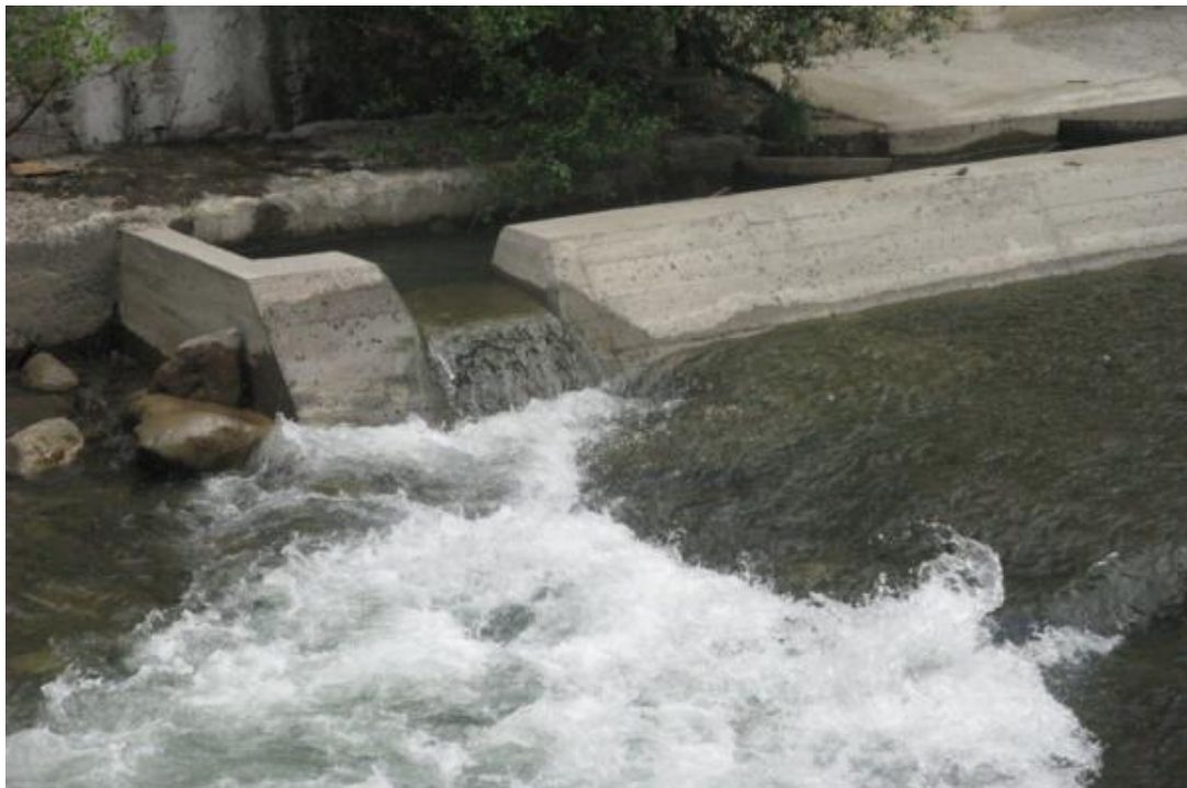
Figura 7. Entrada al paso para los peces del segundo de los pasos desconectada de la lámina del río.
