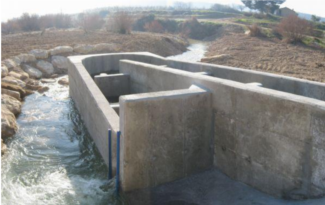
Figura 58. Entrada del paso para los peces cuando se encontraba en funcionamiento
