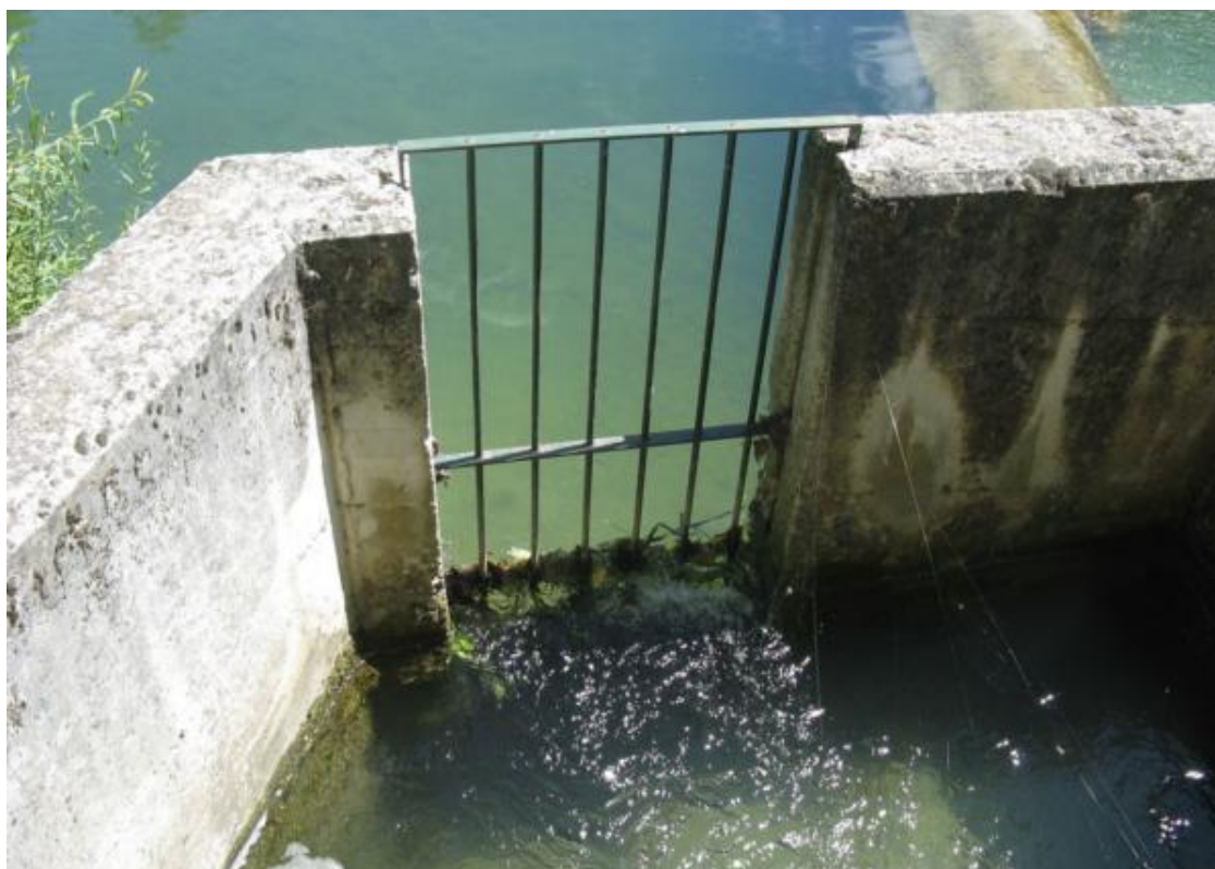
Figura 14. Vista de la salida de la entrada de caudal al paso protegida por una reja para evitar la entrada de flotantes al interior. Sava
