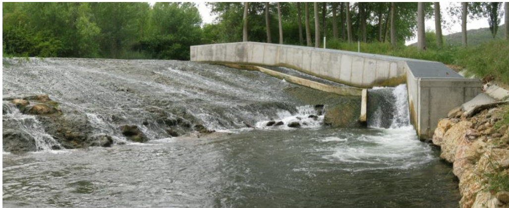
Figura 50. Azud y escala del Molino de Labeaga. La parte superior se ha cubierto con un tramex para evitar posibles accidentes o actos defurtivismo.
