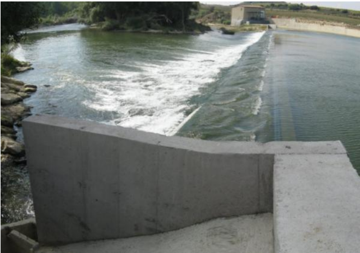
Figura 62. Vista del azud de la CH. de Río Antiguo desde la margen izquierda.
