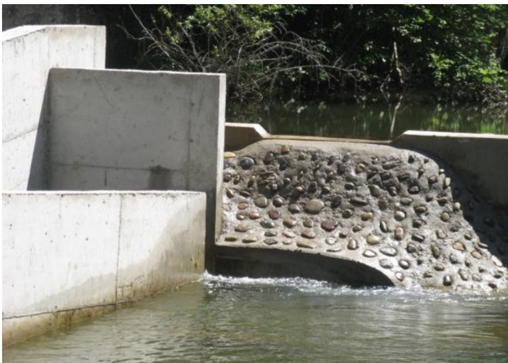
Figura 14. Rebaje en el azud y el tobogán construido para permitir la migración de descenso
