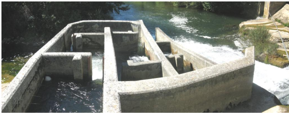
Figura 61. Interior de la escala de la Central Hidroeléctrica de Oroz Betelu
