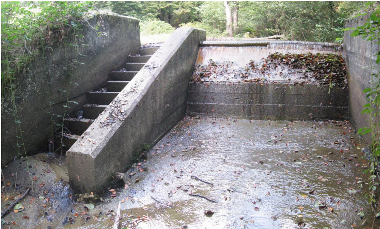
Figura 7. Azud de Barrundia y paso de peces por el cual apenas circula caudal. No existe ninguna poza en la entrada al paso desde donde los peces puedan coger impulso y entrar en él.
