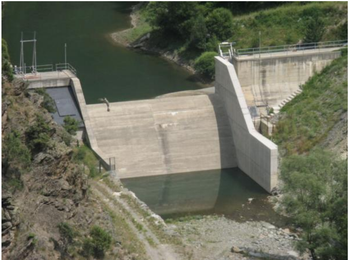
Figura 13. Azud de la CH Malpás. El ascensor es igual al del azud de la CH de Montenartó. No obstante, este paso quedó fuera de servicio después de registrarse una fuerte crecida en el barranco que finaliza en la margen izquierda del azud. Como puede apreciarse el muro de la derecha, donde se localiza en el ascensor, está reconstruido recientemente.
