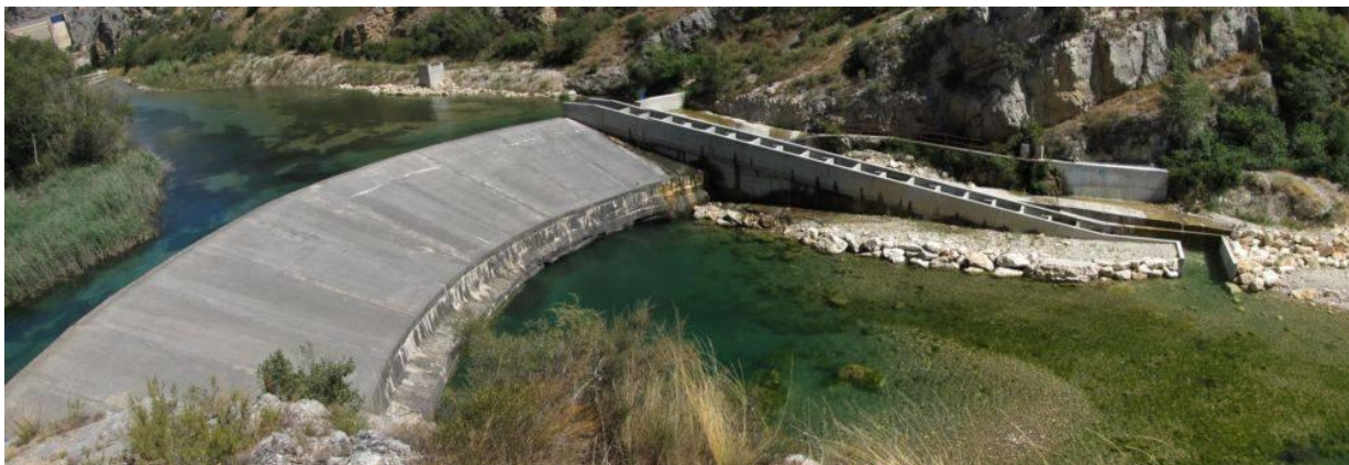
Figura 78. Azud y escala de peces de artesas sucesivas del Canal de Pinyana. La entrada al paso se encuentra muy alejada de la base del obstáculo y no existe caudal de llamada en la entrada del paso.
