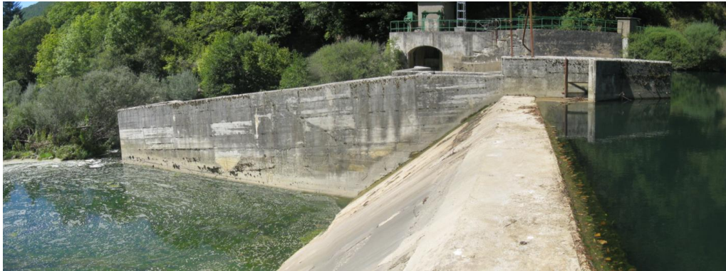
Figura 57. Azud y escala de peces de la Central de Olaladea I. La entrada de caudal al paso está protegida por un deflector para evitar la entrada de flotantes.
