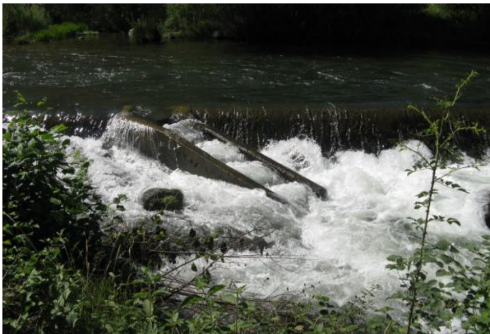
Figura 16. Azud y escala de la toma de la CH de Pradillo (Inchausti), el caudal que circula por la escala es superior al caudal de diseño del paso, como consecuencia de ello se genera un incremento de la velocidad y potencia que las hace imposible que los peces puedan remontar el paso
