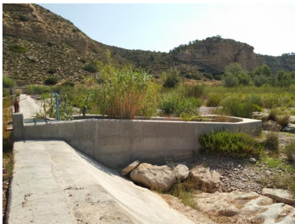
Figura 55. Vista de la escala de peces. Durante la crecida de marzo de 2015 se colmataron las artesas.
