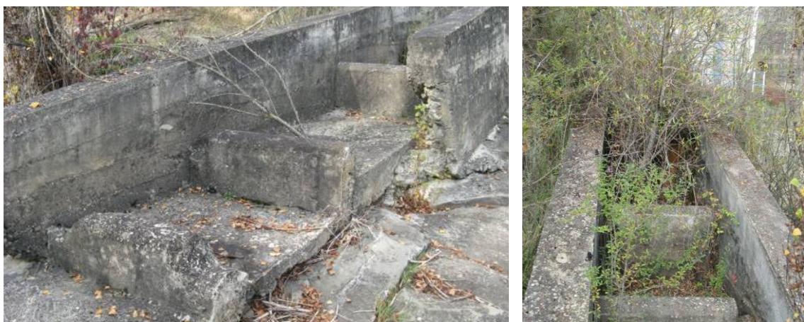
Figura 26. Detalles de la escala de la C.H de Jaravella parcialmente destruida (izquierda) y artesas colmatadas en las que ha crecido vegetación arbustiva (derecha).
