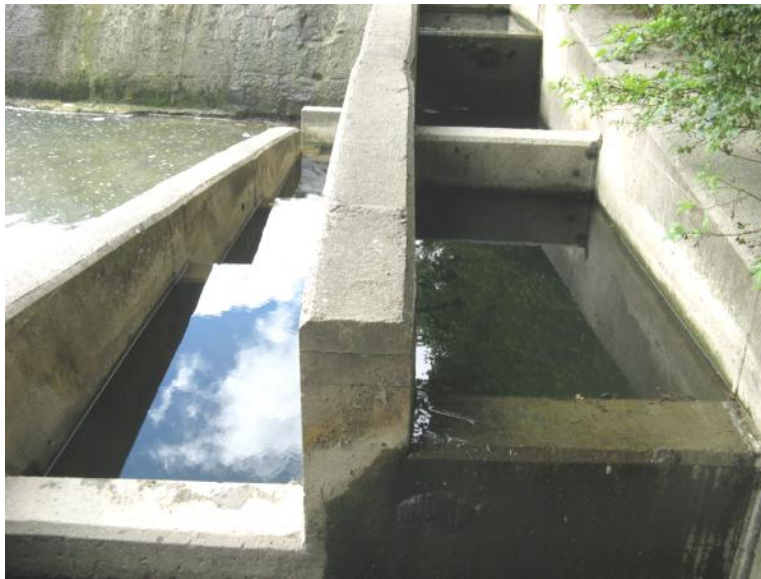
Figura 24. Vista del interior de la escala, el vertido entre estanques se realiza mediante vertido libre, como se puede observar los tabiques carecen de vertederos así como de orificios de limpieza, lo cual favorece la colmatación de los estanques.
