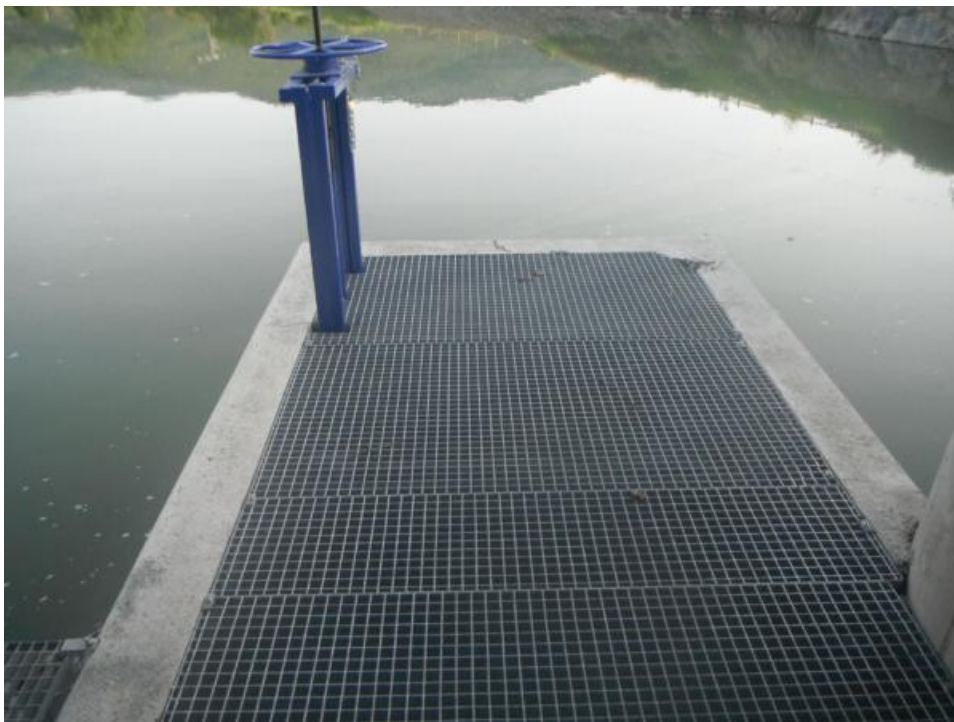
Figura 64. Detalle de la compuerta de volante para regular la entrada de caudal al paso
