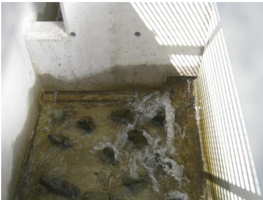
Figura 31. Detalle del interior de una artesa en la que se han colocado bloques para incrementar la rugosidad.
