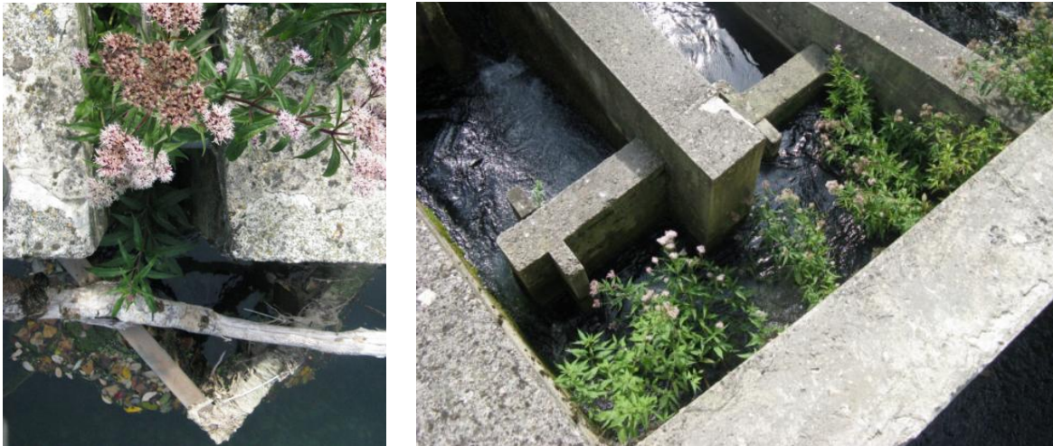
Figura 46. Izquierda, entrada de caudal al paso antiguo, donde se ha instalado un deflector para minimizar la entrada de flotantes al paso. Derecha, tabiques interiores de la escala donde se puede observar el doble deflector
