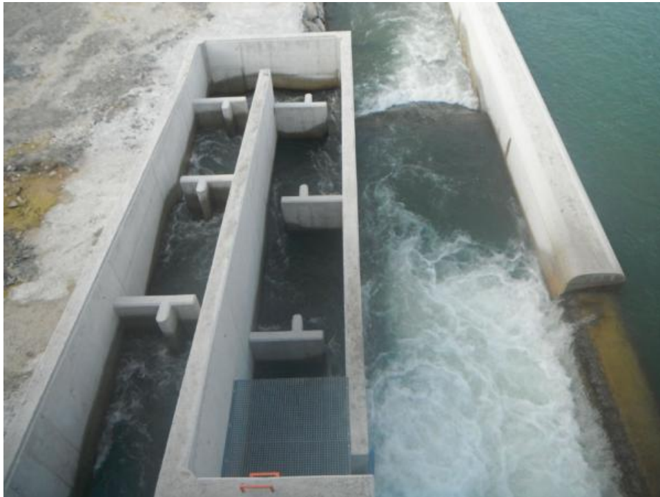
Figura 65. Interior de la escala azud de la presa de cola de Itoiz. A la derecha de la imagen se aprecia el rebaje en el muro del canal lateral para concentrar mayor caudal en la entrada del paso
