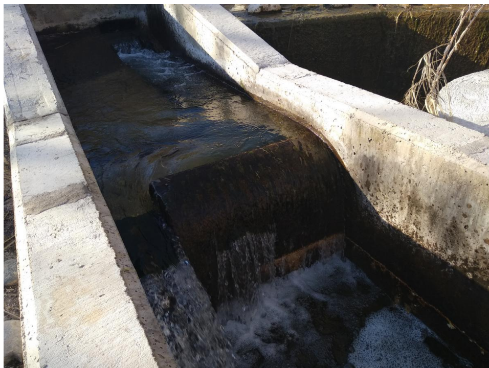
Figura 70. Salto entre arquetas mal dimensionado de la segunda tramada de la escala del de la huerta nueva de Cretas
