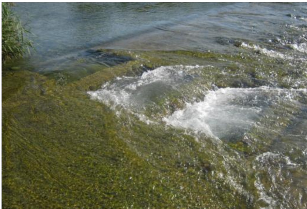
Figura 27. Detalle de la entrada de caudal y las artesas del paso del azud de la piscifactoría de Santa Ana las cuales se encuentran muy colmatadas.
