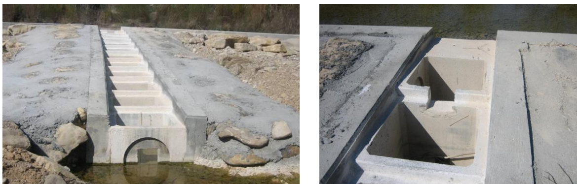
Figura 52. Vista de la entrada a la escala para los peces (izquierda) y de caudal (derecha). Este paso no es permeable para ninguna especie presente en el río Matarraña ya que su diseño no es correcto.
