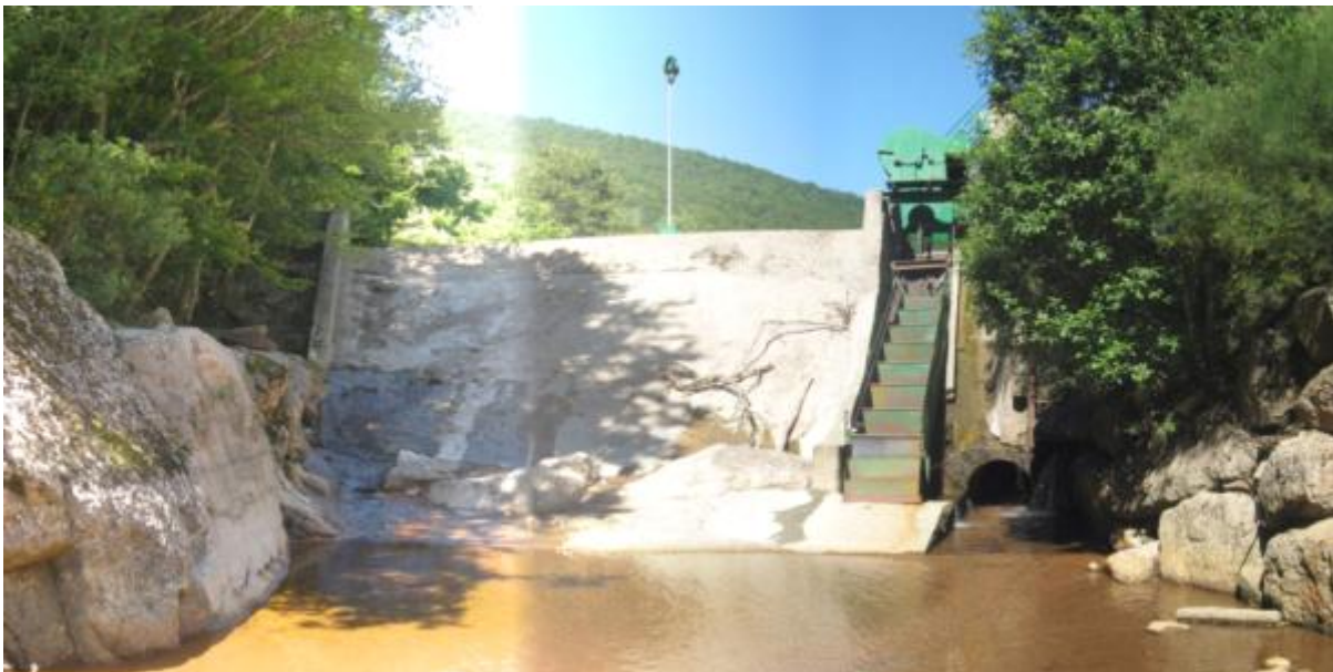
Figura 4. Presa de la CH de Zumañón y escala de peces durante un periodo de aguas bajas. El material (metal) utilizado para el paso puede provocar heridas a los peces a la hora de intentar remontar el paso, de ahí que no sea el más adecuado para la construcción de pasos de peces.
