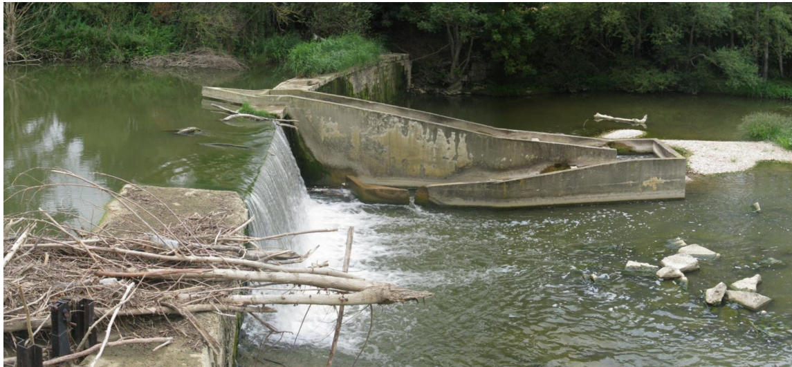
Figura 28. Escala del azud de la CH Satrústegui.
