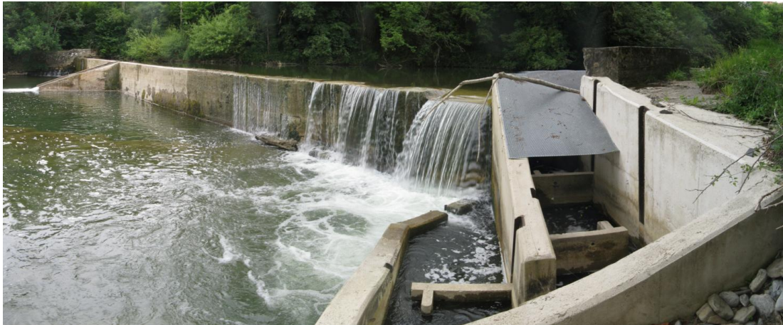
Figura 85. Escala de peces del azud de la CH del Molino de Sarriés, emplazada en el costado de la margen izquierda. El vertido entre estanques se produce a través de vertederos semisumergidos.
