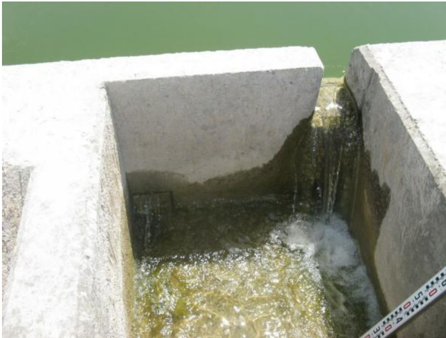
Figura 64. Detalle de la entrada de caudal al paso del azud de la C.R. del Embatallador. El orificio de fondo, por donde entra parte del caudal, se encuentra obstruido no entrando apenas caudal en la escala.
