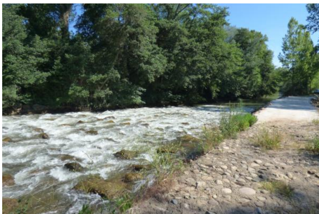
Figura 47. Rampa de bloques de perturbación del azud de la C.R. Ciudad de Cenicero hacia aguas abajo.
