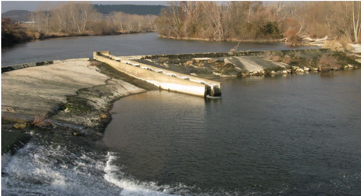
Figura 65. Escala de artesas sucesivas del azud de la CH de Buicio, localizado en el costado de la margen derecha. La foto se corresponde con un periodo de aguas bajas, durante estos periodos apenas circula caudal por el paso ni existe caudal de llamada.
