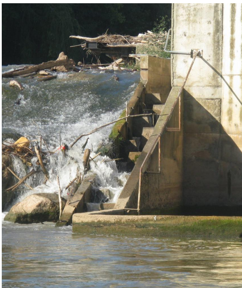
Figura 76. Vista del paso de peces de la CH. de Logroño fuera de uso, apenas circula caudal por él y al no estar sobredimensionados los muros laterales entra caudal desde el paramento del azud.
