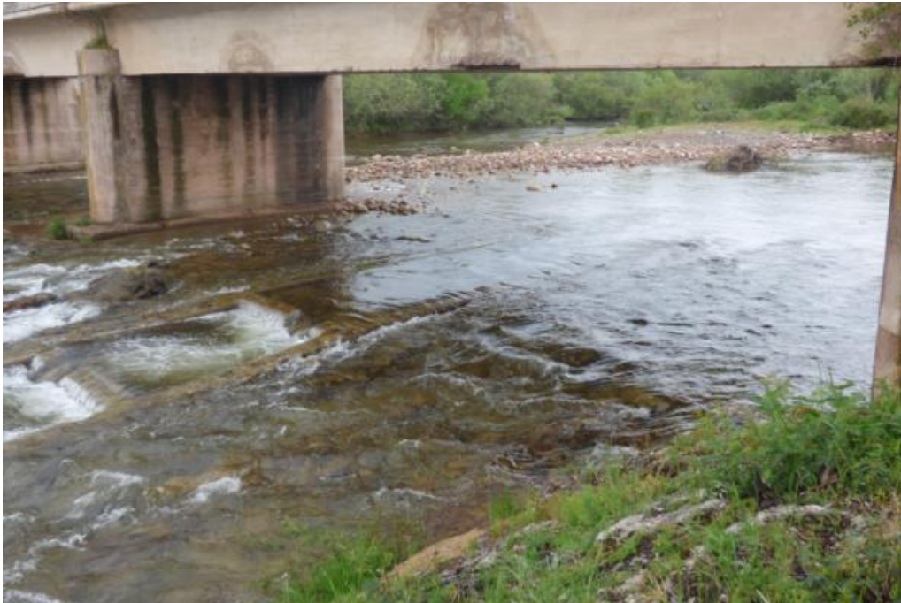
Figura 14. Detalle de la entrada de caudal del paso. En momentos de caudales altos, como el de la foto, entra demasiado caudal en el paso.
