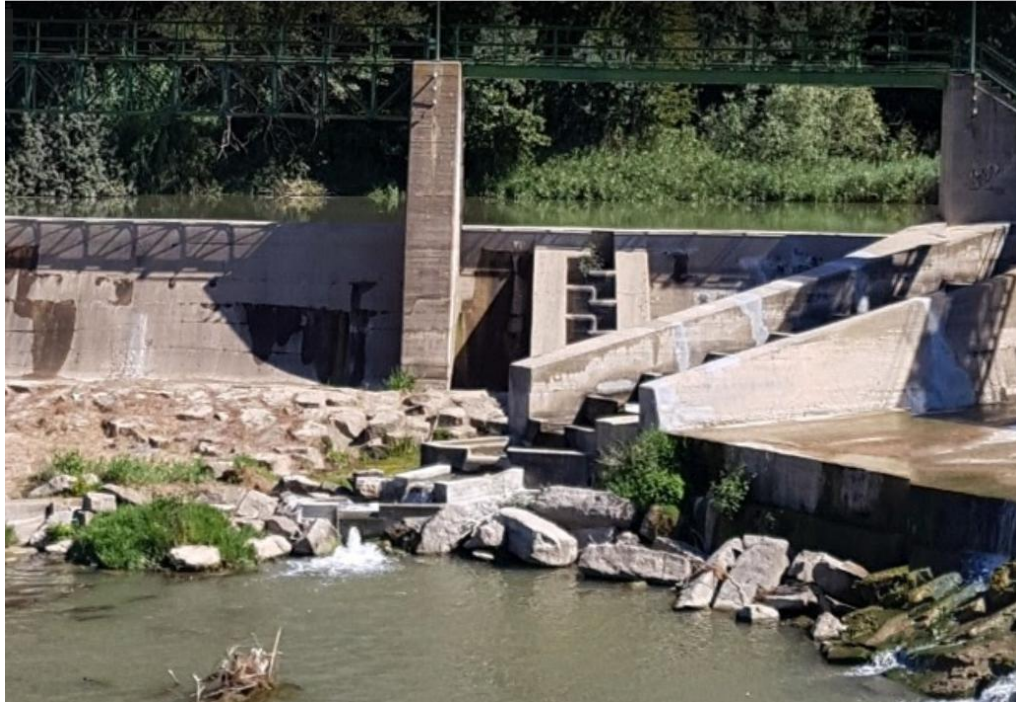
Figura 65. Detalle de las nuevas artesas construidas (3) en el paso de peces para solventar el problema de la desconexión de la entrada del paso con la lámina de aguas abajo del azud. Como puede apreciarse el vertido entre la última artesa y el río es desde el orificio sumergido y no desde el vertedero. (Fuente foto: Carlos Andrés Pérez, Google Street, año 2017)
