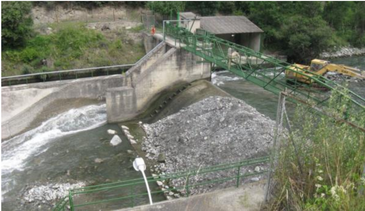
Figura 51. Azud y el paso de artesas sucesivas en vertido libre de la CH Valira.
