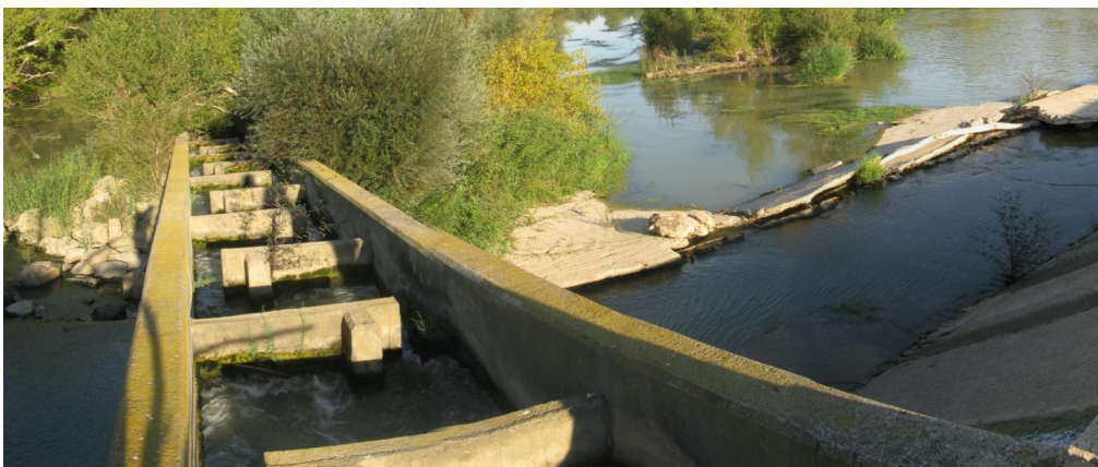
Figura 95. Interior de la escala del azud de la CH. Electra Tudela, donde se observa como la vegetación ha colonizado algunas de las artesas.
