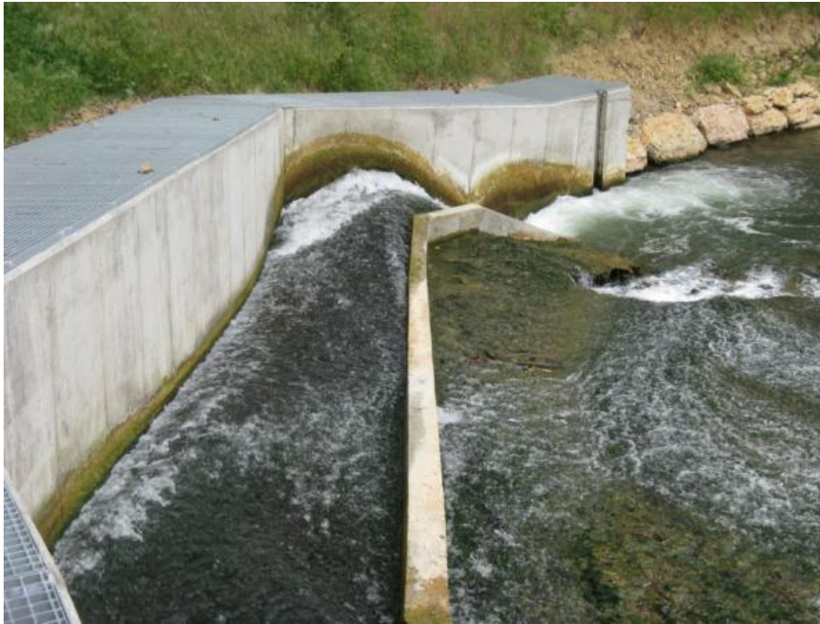
Figura 52. Tobogán construido junto a la escala del azud del Molino de Labeaga para incrementar el caudal de llamada en la entrada del paso
