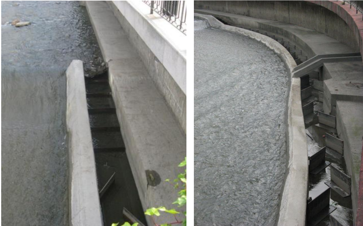
Figura 10. Izquierda, entrada de caudal del tercer paso donde se aprecian los tabiques metálicos y dos deflectores. Derecha, detalle del interior del paso completamente seco.
