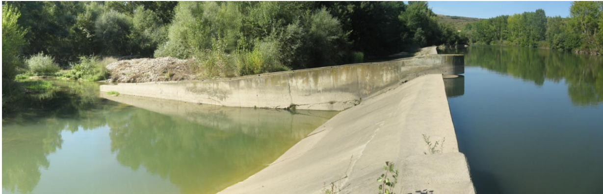
Figura 12. Escala del azud de la CH de Labastida emplazada en el centro de la estructura transversal. Durante la visita se estaban realizando labores de mantenimiento y la escala no se encontraba en funcionamiento
