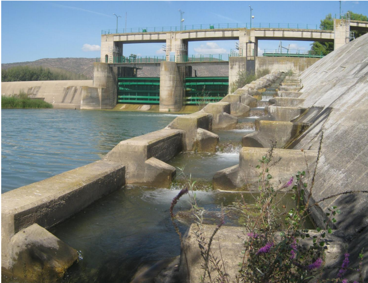
Figura 59. Azud y parte de la escala de peces de la CH Balaguer. El paso se localiza en el costado izquierdo de la estructura. Presenta una longitud importante, encontrándose la entrada al paso alejada de la base del azud y el vertido entre arquetas es en libre.
