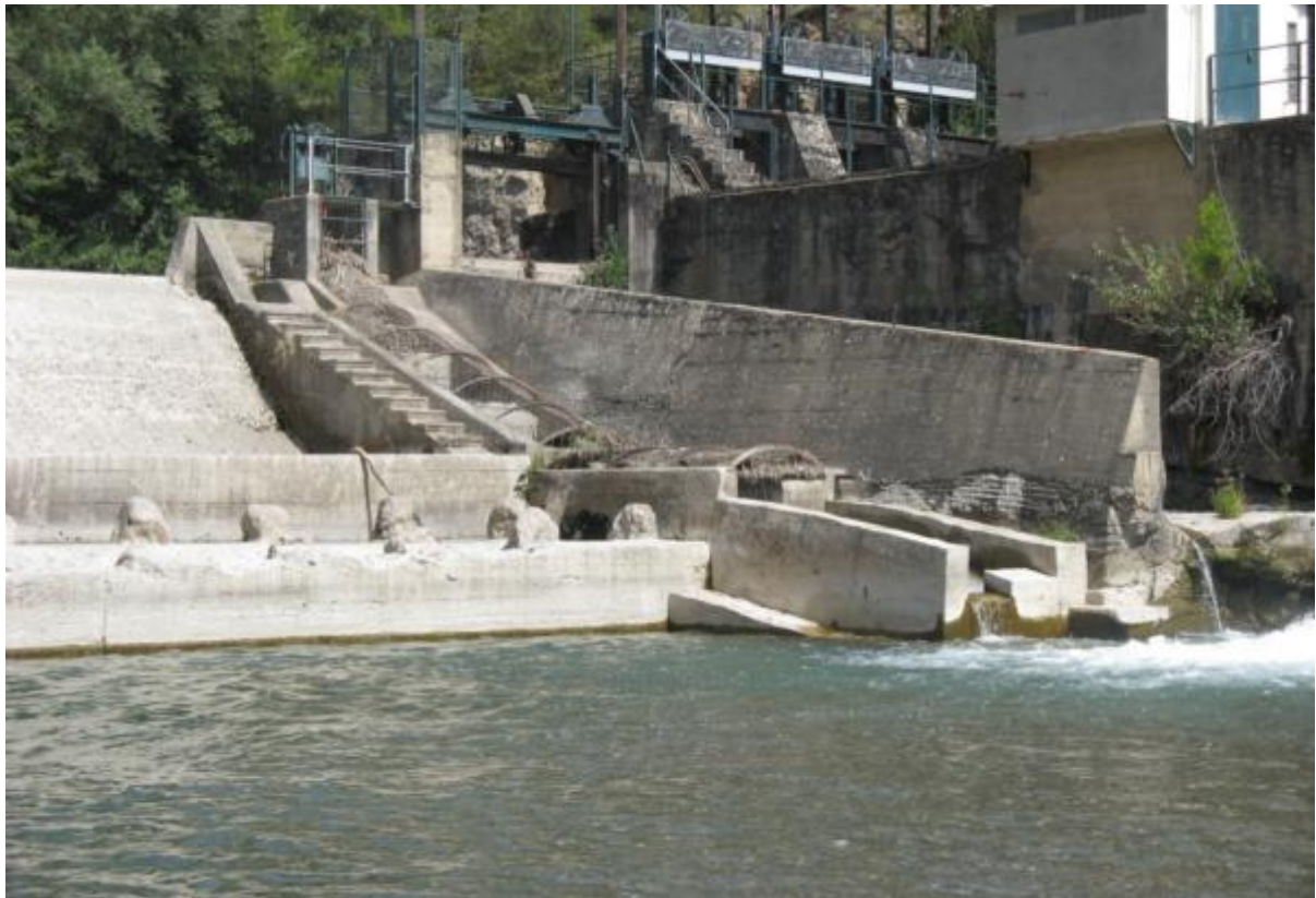
Figura 22. Entradas de la escala de artesas de la presa de Sossis por la que apenas circula caudal. La entrada al paso se encuentra descolgada de la lámina del río de aguas abajo del azud. Las últimas artesas del paso se construyeron en una segunda fase, seguramente por el descenso del nivel del río aguas abajo de la estructura. Cuando circulan caudales altos por el río el nivel de la lámina de aguas abajo se incrementa quedándose la entrada del paso a nivel del río.
