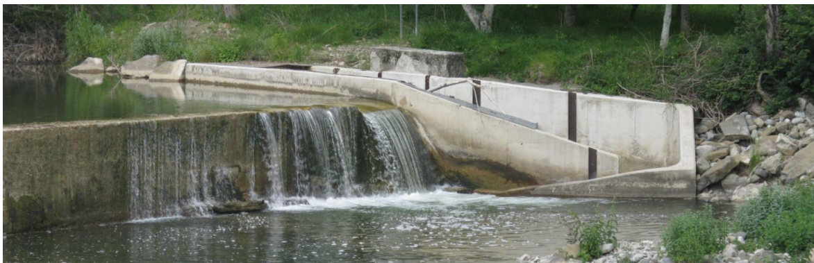
Figura 86. Escala de peces del Molino de Sarriés vista desde la margen derecha del azud. SE ha practicado un rebaje en la coronación del azud para concentrar un mayor caudal a la entrada del paso, aumentando así el efecto llamada.
