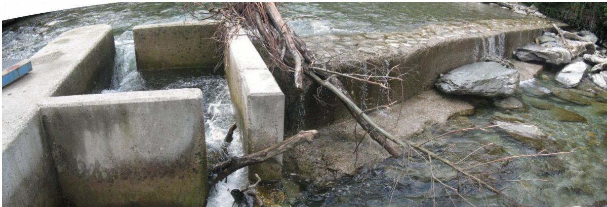
Figura 5. Primera artesa del paso del azud del Ayto. de Llavorsí. Se puede observar que en el momento de la visita en el vertedero había obstruido parcialmente el vertedero que comunica las dos artesas del paso.
