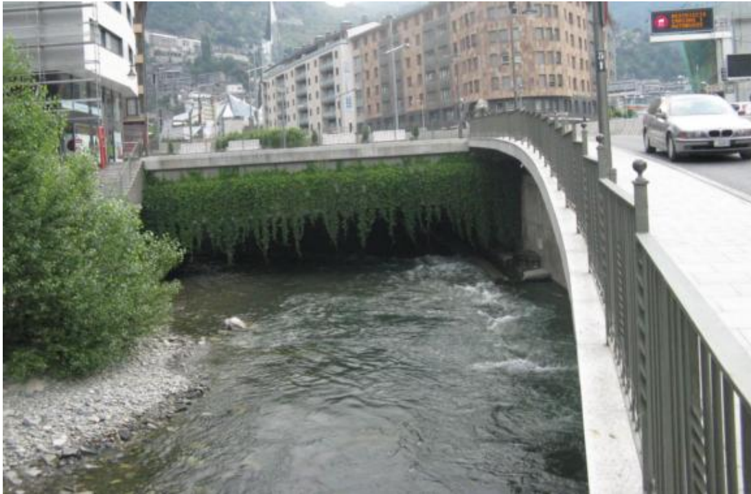
Figura 6. A la derecha de la imagen, entrada de caudal al segundo de los pasos por la cual apenas entra caudal.
