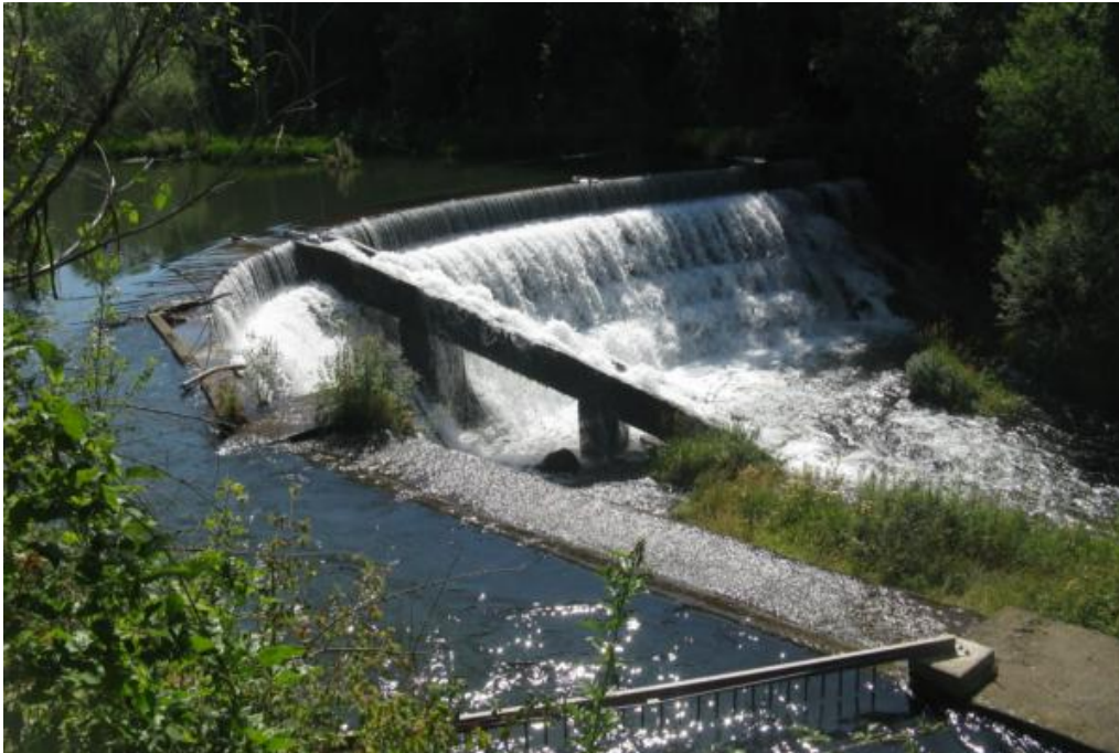
Figura 15. Azud de Toma de Aguas Central de Pradillo (Changoa). Este paso se encuentra desbordado, tanto la entrada de caudal como las artesas están mal dimensionadas.
