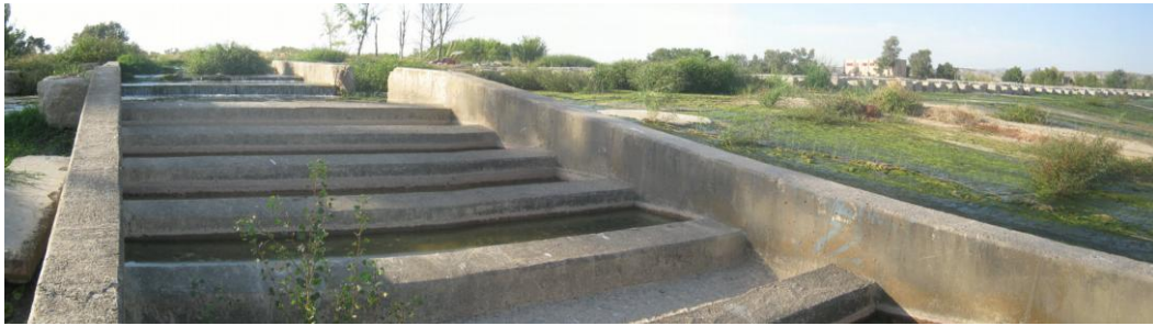
Figura 92. Vista de las artesas sin vertedero de la escala de la margen derecha del azud de la C.H. de Pina..
