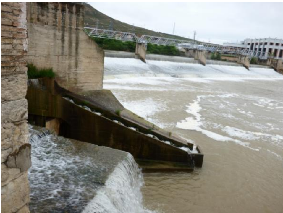
Figura 74. Escala de peces de la CH de Las Norias cuyo grado de funcionamiento es nulo
