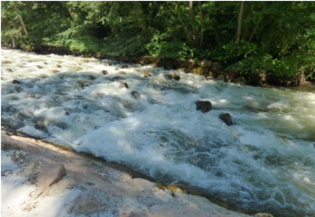
Figura 50. Detalle de la entrada al paso para los pece. Esta zona al no disponer de colchón amortiguador aguas se ha descalzado ligeramente, incrementándose el salto de entrada al paso para los peces.
