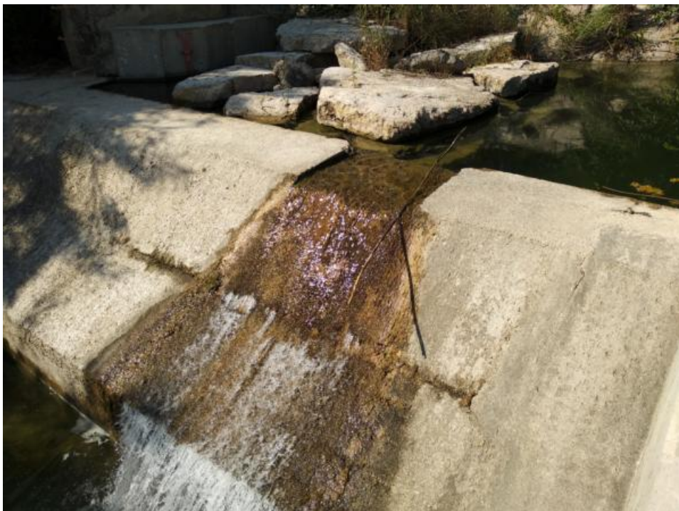
Figura 61. Detalle del rebaje practicado en el azud para incrementar la llamada en la zona de la entrada del paso y permitir la migración de descenso en periodos bajos de caudal
