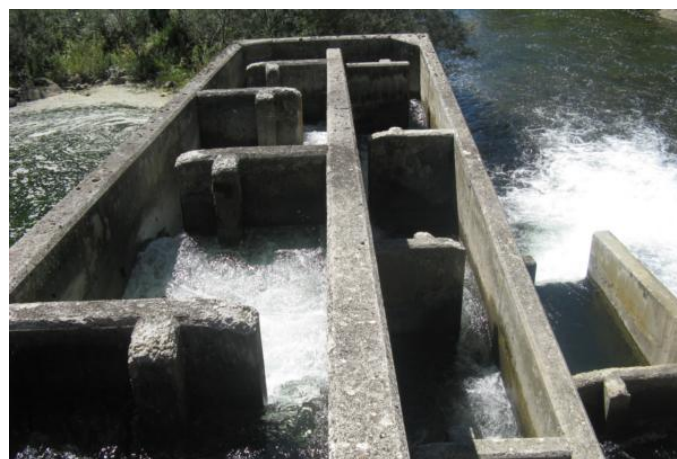
Figura 59. Interior de la escala, se puede observar los vertidos semisumergidos en los vertederos y la asimetría entre el vertedero de entrada y el resto de los vertederos.
