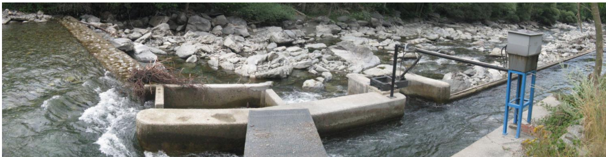
Figura 6. Azud y el canal de derivación del azud del ayuntamiento de Llavorsí.
