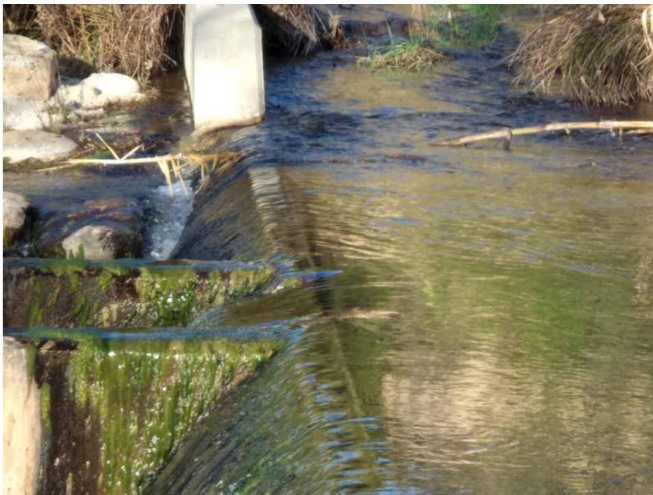
Figura 75. Detalle de la entrada de caudal a la escala de peces del azud de la toma de agua de Arenys de Lledó
