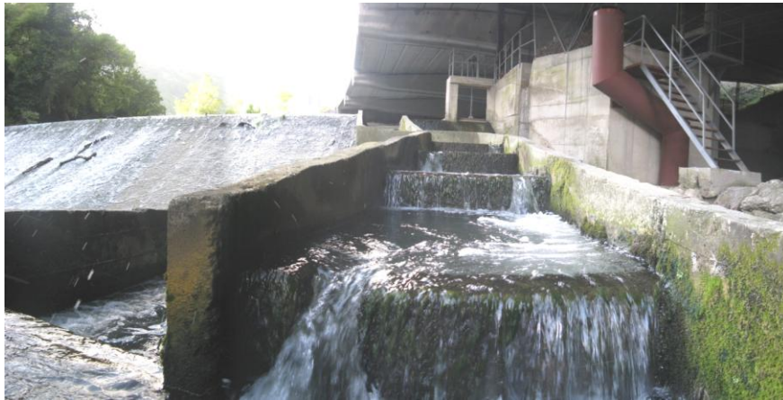
Figura 21. Interior de la escala de la Central de Dos Hermanas; los vertederos construidos en los tabiques presentan una sección insuficiente para poder concentrar el caudal de diseño del paso, en consecuencia, parte del vertido se produce a través de la parte superior del tabique.
