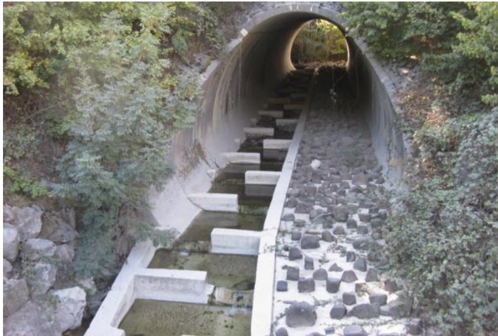
Figura 30. Paso de peces en la canalización del barranco Erreka. La peculiaridad de este paso es que combina dos modelos de estructura de permeabilización; en la sección izquierda existe una escala de artesas y vertederos libres, mientras que en el lado derecho se ha construido una rampa de bloques de piedra.
