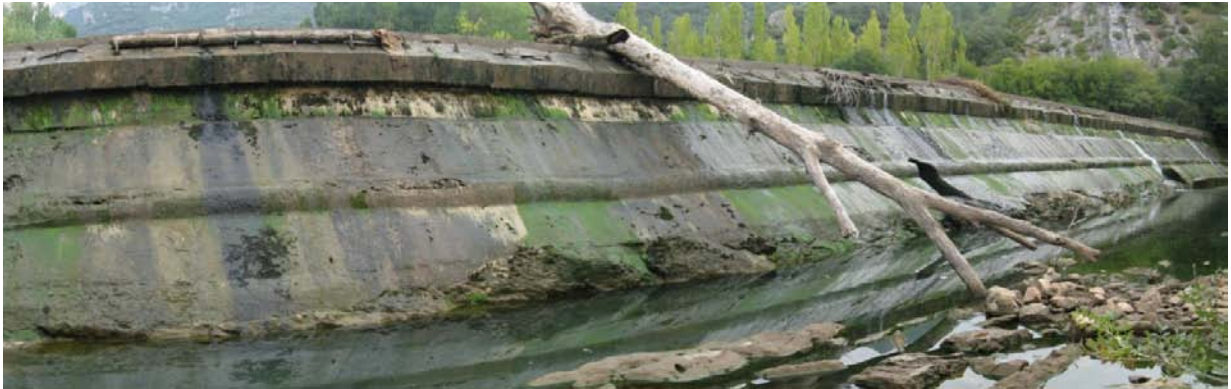
Figura 3. Vista del azud de la CH de Valdenoceda por el que no vierte apenas caudal quedándose el río prácticamente seco aguas abajo del azud.
