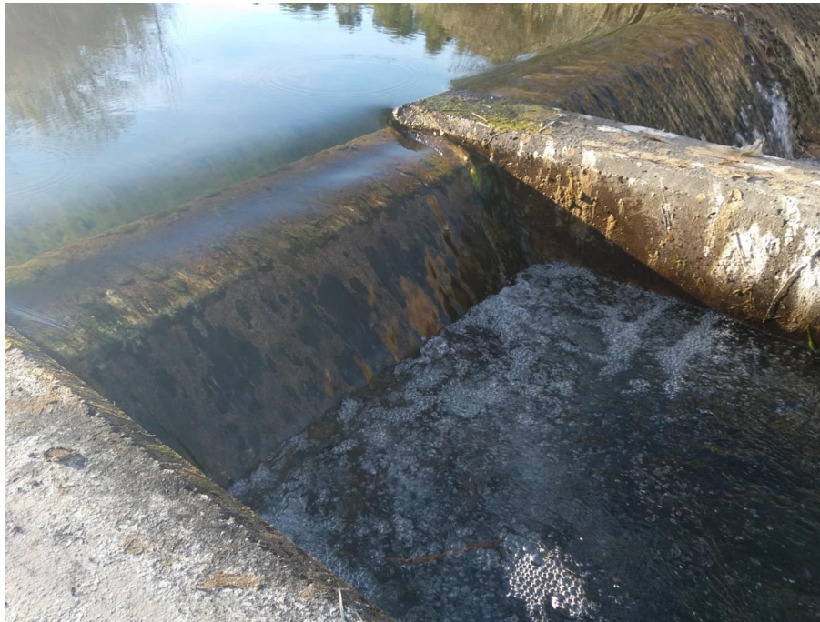
Figura 68. Entrada de caudal a la escala de peces del Azud de la huerta nueva de Cretas. Tanto el salto existente entre la lámina de agua de la primera artesa y la del remanso del azud como su dimensionamiento no son correctos.
