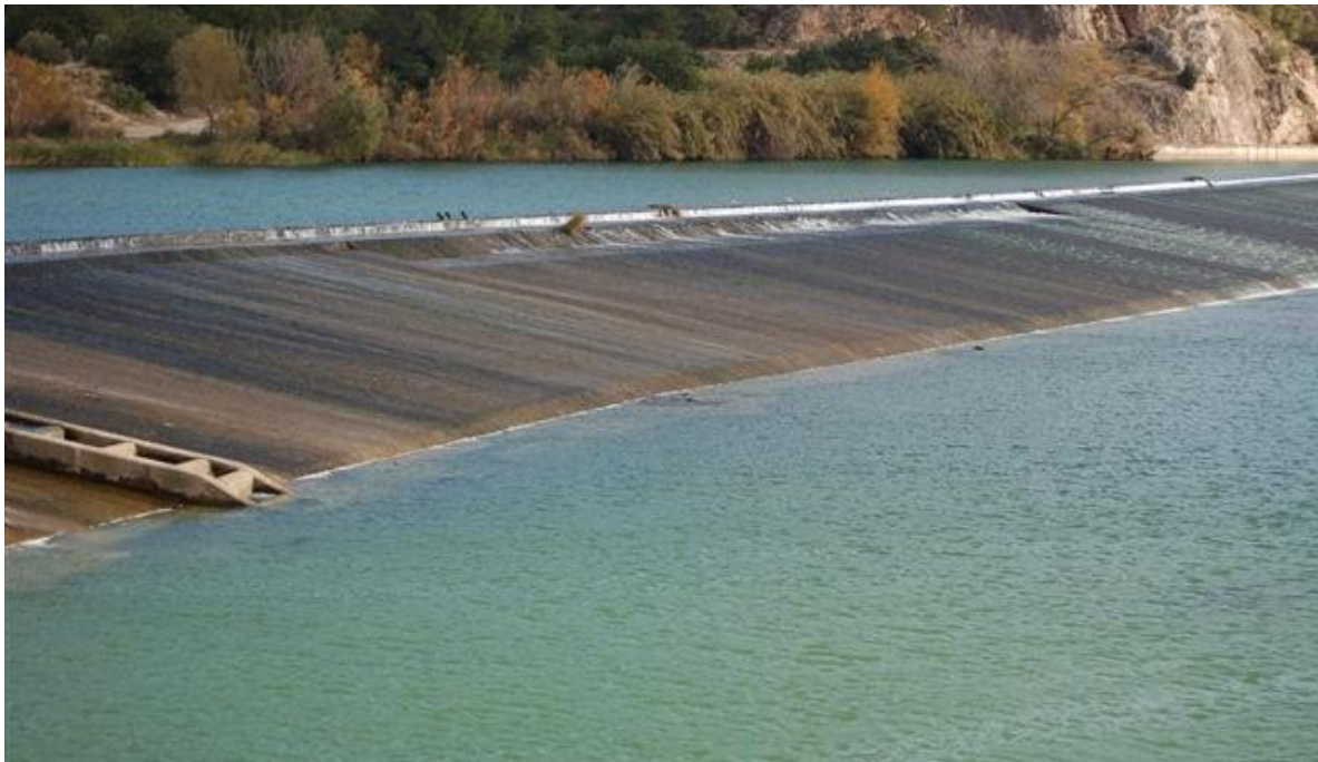
Figura 73. Detalle de la entrada a la escala antigua por la que no circula caudal. Como puede apreciarse la primera artesa se encuentra desconectada de la lámina del río de aguas abajo del azud.
