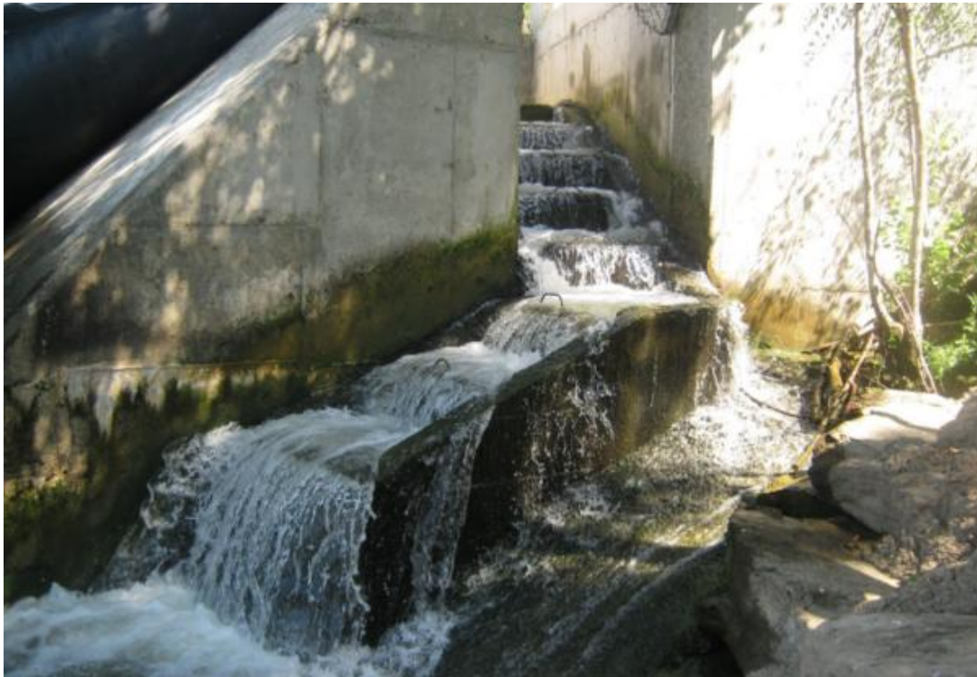
Figura 63. Escala de artesas del azud de la CH de Río Antiguo totalmente desbordada donde se puede apreciar el salto que hay entre la lámina del río de aguas abajo del azud y la primera artesa
