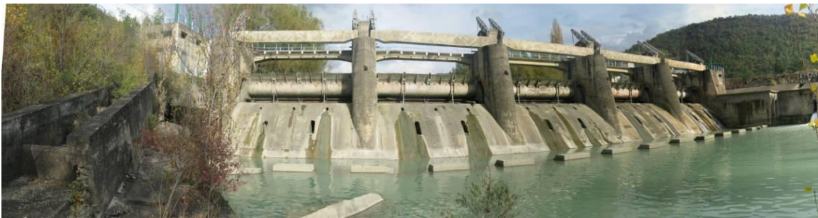
Figura 25. Vista de la del azud y la escala de artesas del azud de la C.H. de Jaravella la cual se encuentra parcialmente destruida, colmatada encontrándose fuera de uso.
