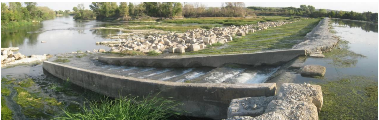
Figura 93. Escala de peces de la margen izquierda del azud de la C.H. de Pina.
