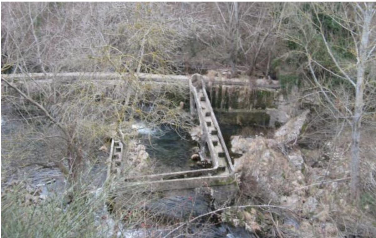
Figura 39. Azud del antiguo molino García Baquero. El paso se encuentra destruido y fuera de uso.
