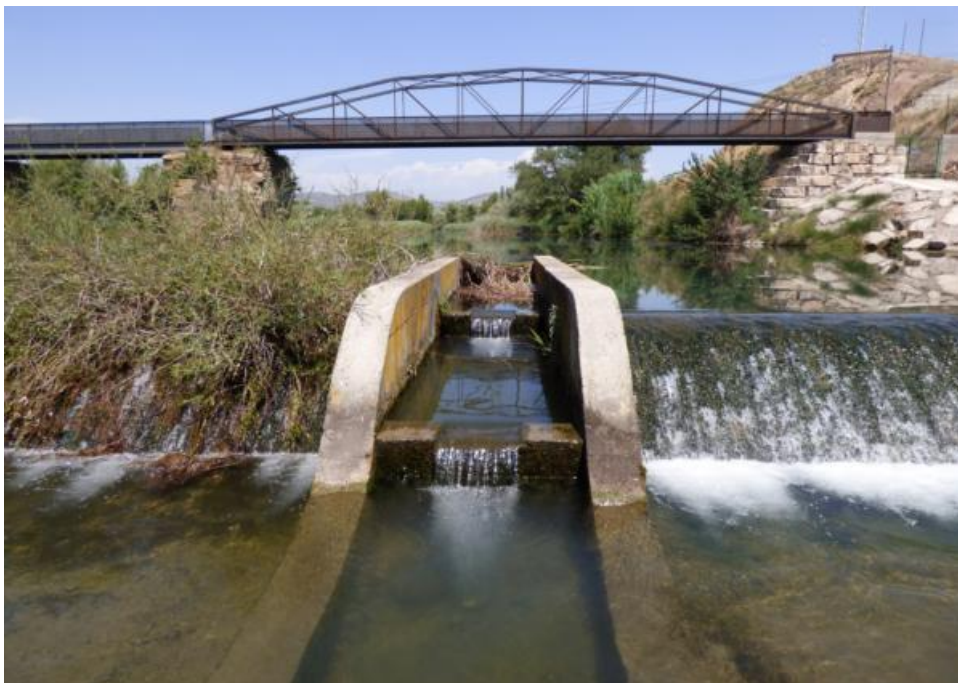
Figura 33. Escala del azud de azud de Alguerrí-Balaguer visto desde aguas abajo donde se aprecia el vertido en libre entre artesas y la obstrucción de la entrada de caudal al paso.
