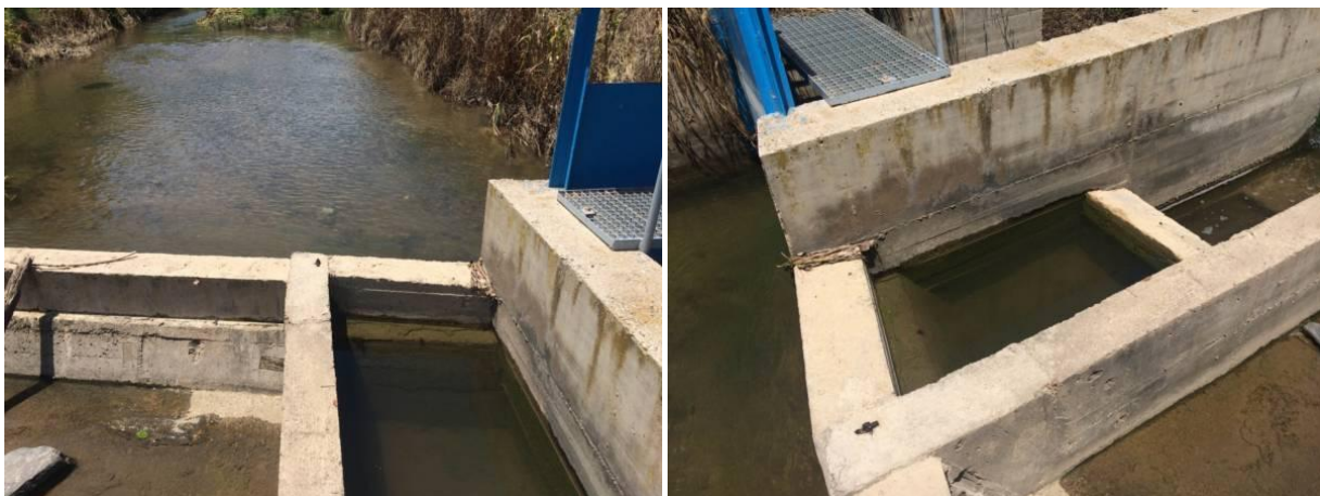
Figura 81. Azud y la escala de peces de artesas sucesivas del azud de la CR de Ablitas. La entrada de caudal al paso está al mismo nivel que la rasante del azud.
