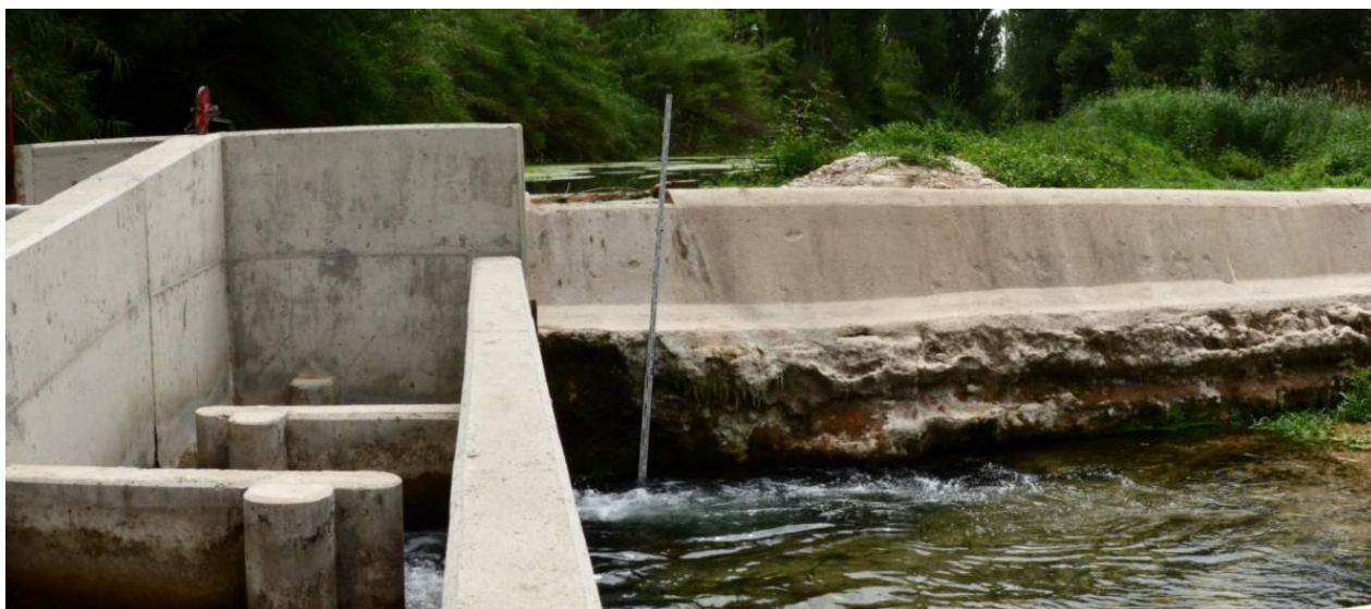
Figura 47. Vista panorámica del azud, la escala de peces y el rebaje practicado en el azud al objeto de permitir las migraciones de descenso y generar un caudal de llamada en la entrada al paso para los peces.
