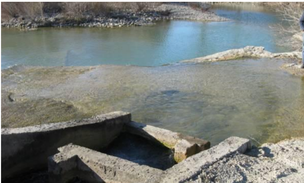
Figura 32. Vista de la poza de entrada a la escala del azud de la estacada de la Huerta Alta del Gállego donde se aprecia que no existe caudal de llamada que provoque la atracción de los peces a la entrada del paso.
