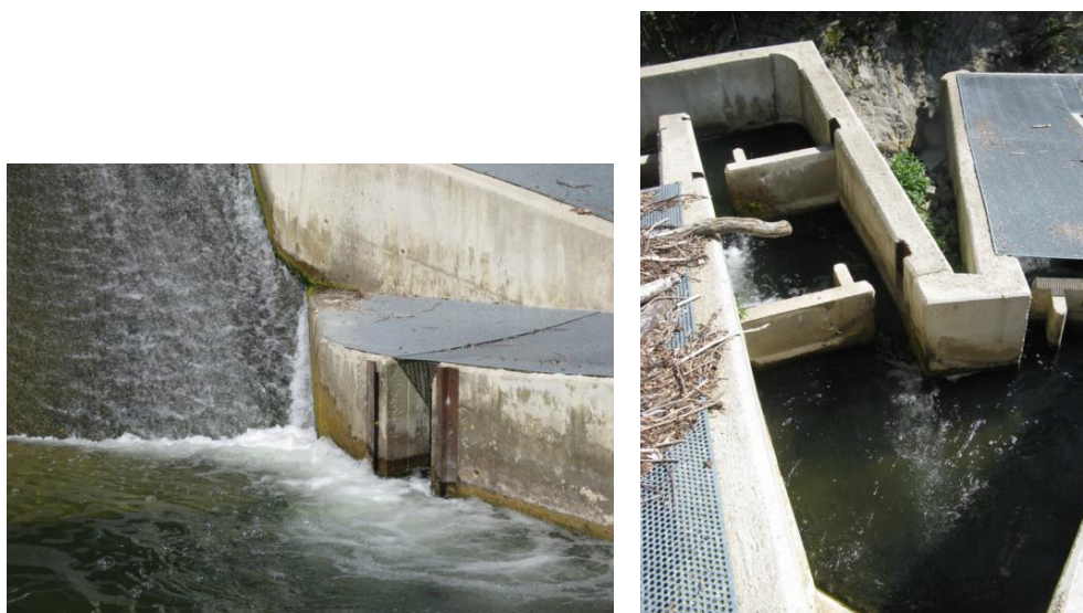
Figura 84. Izquierda, entrada para los peces al paso de peces del azud de la Electra Molino de Esparza de Salazar. El efecto llamada se ve favorecido por el caudal aportado por el rebaje existente en el azud. Derecha, Vista interior de parte de la escala de peces.
