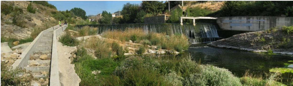
Figura 40. Vista del azud de la Fábrica del Pont Nou y la escala de peces que se encuentra fuera de uso.
