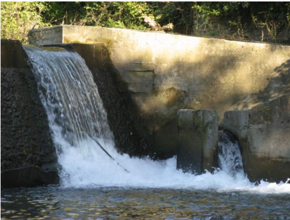
Figura 33. Entrada al paso para los peces, desconectada de la lámina de agua del río aguas abajo del azud. También se aprecia el rebaje practicado en el azud para concentrar caudal en la entrada del paso y facilitar las migraciones descendentes.
