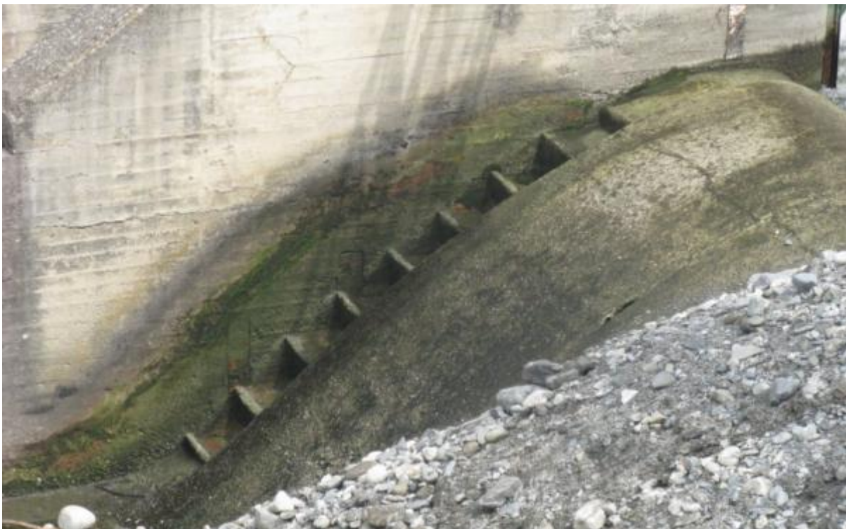
Figura 52. Escala del azud de la CH de Valira, este paso presenta una pendiente muy elevada y unas artesas con un calado y un volumen muy reducido, lo que hacen que esta estructura sea infranqueable para los peces presentes en el río Valira.
