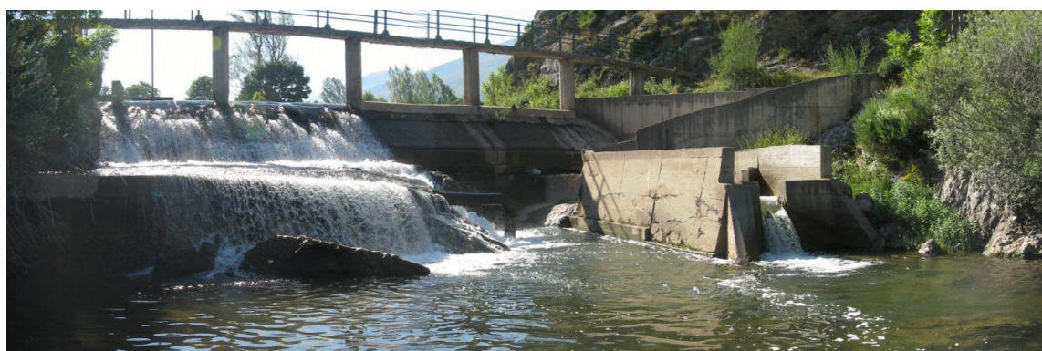
Figura 8. Escala de peces del azud de la toma de aguas de Reinosa en Espinilla. Antes de la última actuación, con caudales bajos, la entrada al paso quedaba descolgada de la lámina de aguas abajo del azud.
