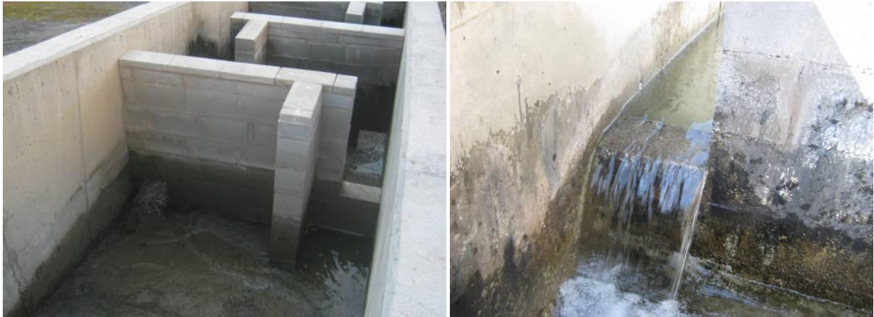
Figura 79. Detalle del interior del paso. Las aristas de los vertederos y los deflectores son vivas, pudiendo provocar daños a los peces. Los deflectores se encuentran muy próximos al vertedero, deberían tener una longitud igual al ancho del vertedero y colocarse a esa misma distancia de la rasante del vertedero. En la imagen de la derecha se aprecia la poca carga de vertido en los vertederos.
