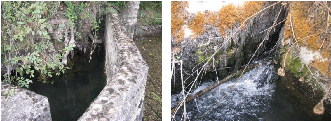
Figura 49. Izquierda, entrada de caudal al paso. Derecha, entrada al paso para los peces. Tanto la entrada de caudal como la de los peces se encuentran colmatadas de sedimentos condicionado su correcto funcionamiento
