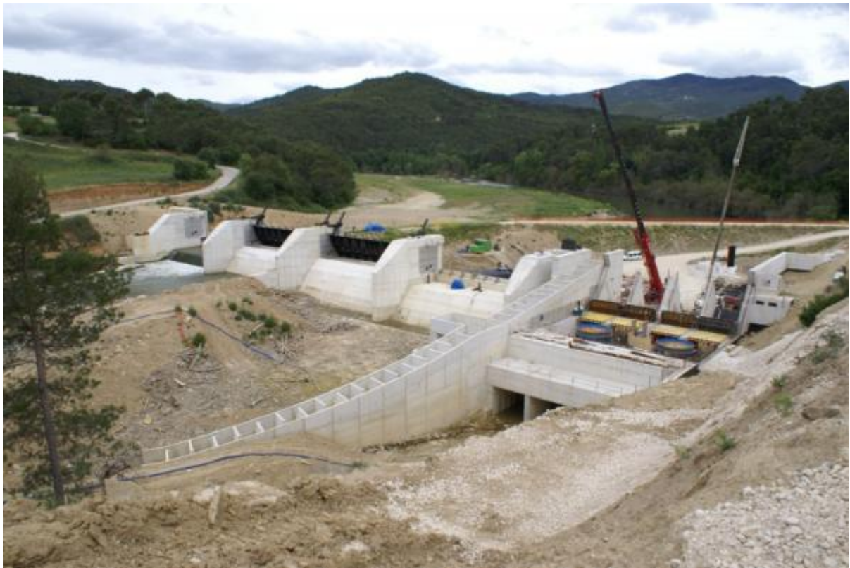
Figura 34. Azud y escala de artesas sucesivas en construcción de la presa Señorío de Sarria II
