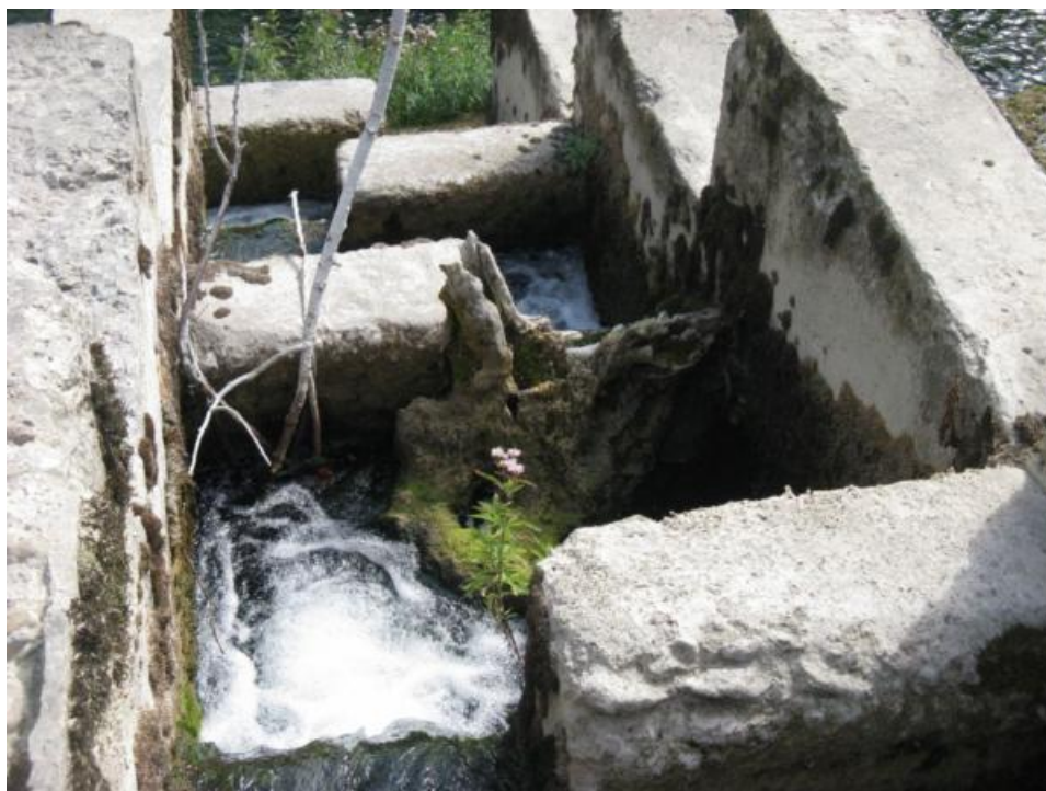
Figura 44. Vista del interior de la escala antigua de la piscifactoría de Zudaire donde se puede ver los tabiques que dividen los sucesivos estanques carecen de deflector y presentan vertidos en libre con saltos entre estanques superiores a los límites fijados para las especies presentes en la zona.
