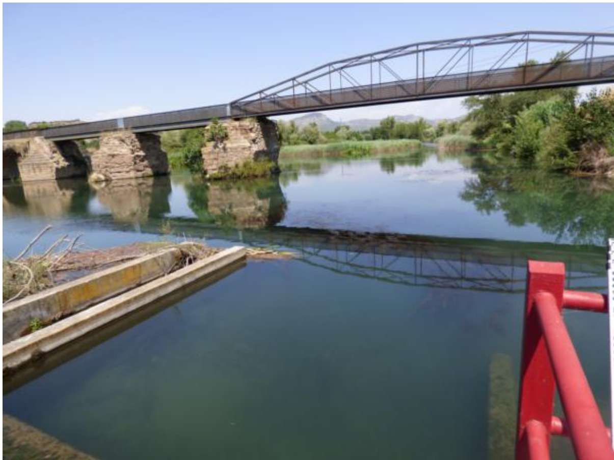
Figura 31. Detalle de la entrada de caudal al paso la cual está obstruida por materia orgánica.
