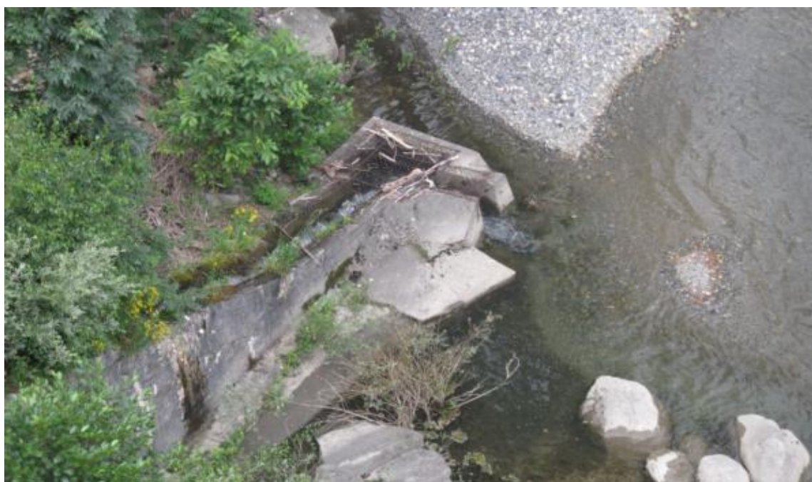
Figura 4. Detalle de la entrada a la escala por la que apenas circula caudal y no existe caudal de llamada.
