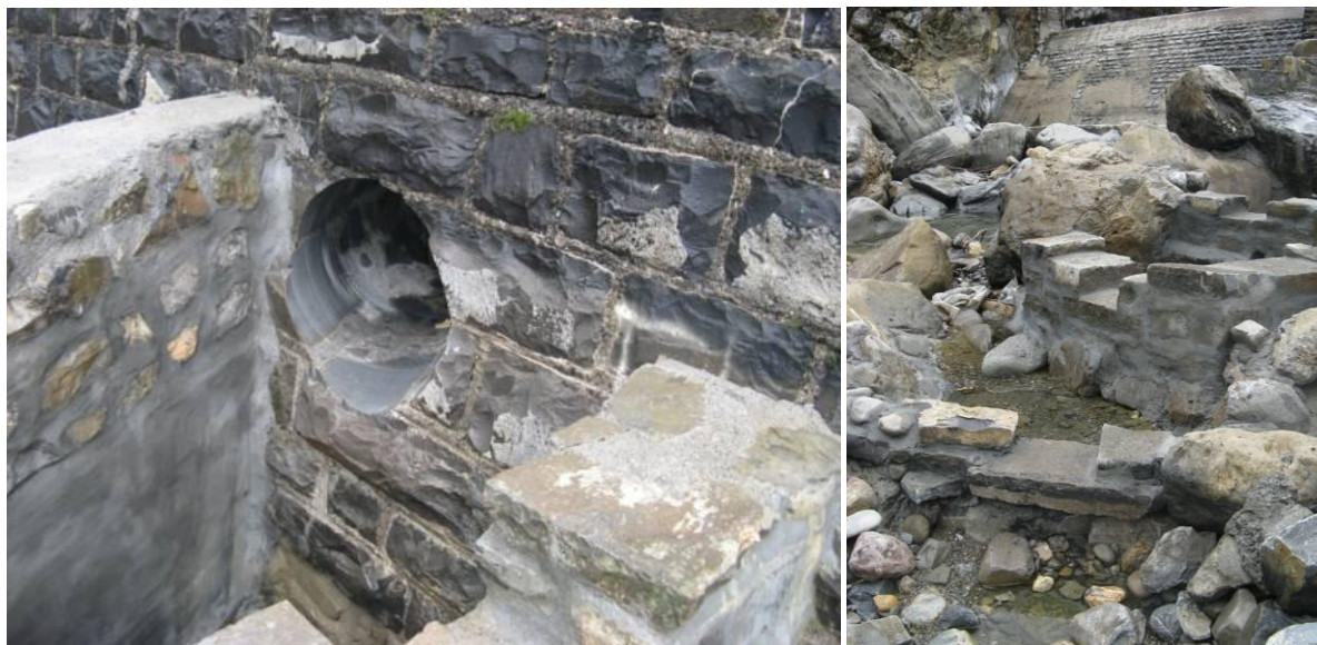
Figura 23. Detalle del orificio de entrada de caudal de la escala de peces de la C.H. Biescas I (izquierda), esta entrada no es adecuada por la oscuridad que presenta y porque se puede obstruir fácilmente. A la derecha entrada para los peces al paso, ésta no dispone una poza con que tenga un calado suficiente para que el pez pueda coger impulso y entrar a la escala
