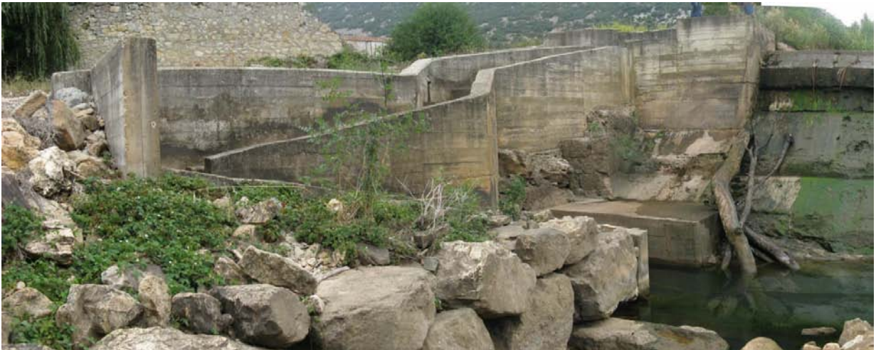
Figura 4. Vista de la escala de peces desde aguas abajo, por la cual no circula caudal.
