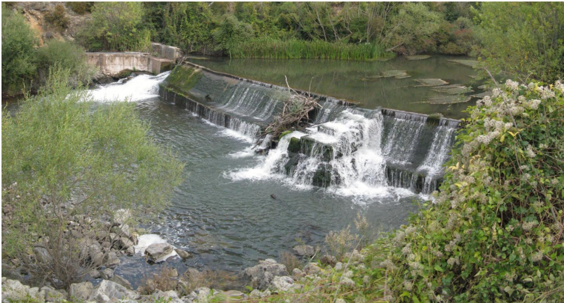
Figura 17. Azud y escala de peces de la Piscifactoría de Torrecilla que se encuentra abandonada y destruida.
