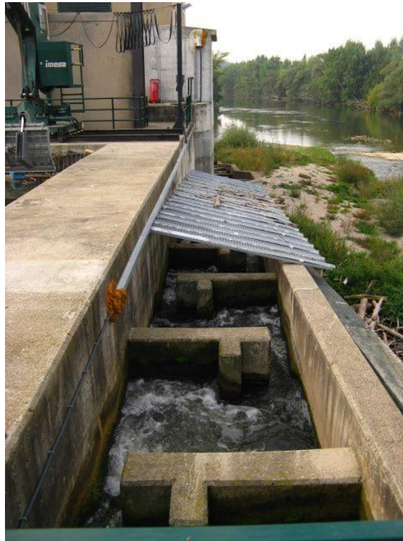
Figura 10. Escala de artesas sucesivas del azud de la CH del Molino de Suso. La escala se emplaza en el costado de la margen izquierda, junto al canal por donde se derivan los caudales turbinados. El emplazamiento es correcto porque se encuentra próximo a la zona donde se derivan los caudales turbinados, los cuales hacen de llamada para atraer a los peces.
