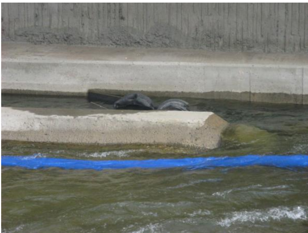
Figura 5. Entrada de caudal al primer paso obstruida por dos neumáticos.
