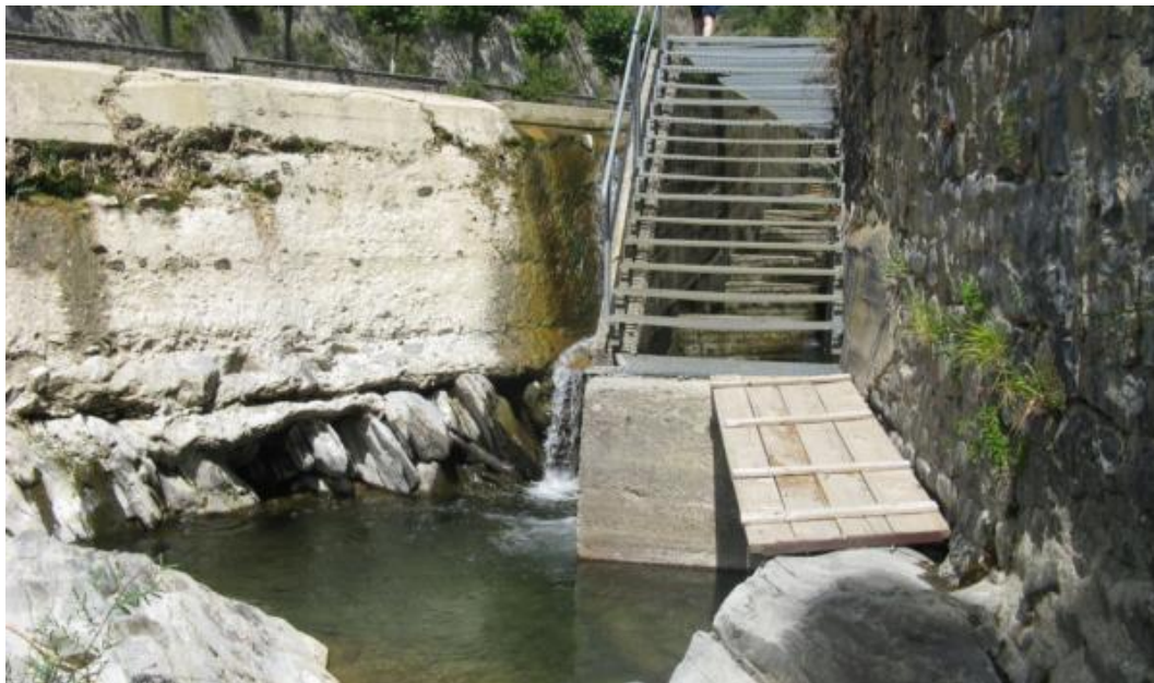
Figura 12. Costado izquierdo del azud donde se ha practicado un rebaje para concentrar mayor caudal en la entrada del paso.
