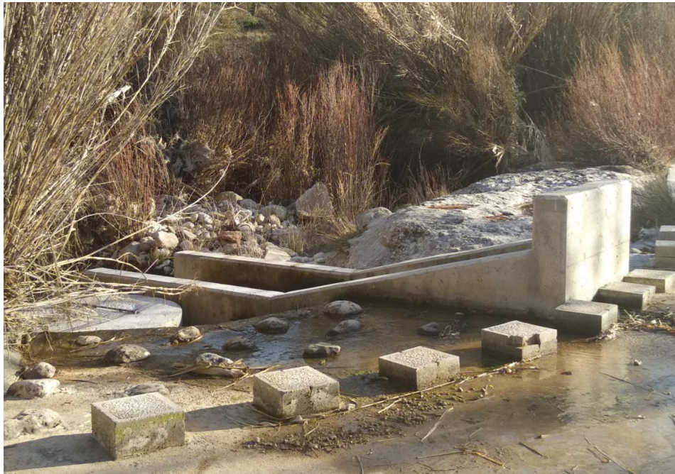
Figura 66. Vista de la segunda tramada de la escala de peces del Azud de la huerta nueva de Cretas
