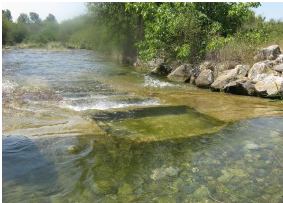
Figura 29. Detalle de la entrada de caudal al paso del azud de la piscifactoría de Santa Ana. El diseño de esta entrada no permite regular la entrada de caudal al paso dependiendo del nivel de la lámina en la coronación del azud.
