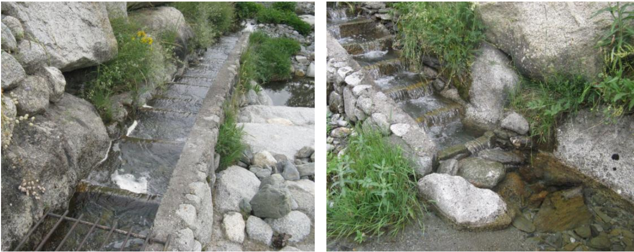
Figura 15. Escala de artesas sucesivas en vertido libre (izquierda) del azud del Salto de Tavascan y la entrada a la misma (derecha) la cual se encuentra parcialmente obstruida por bolos de grandes dimensiones, haciendo muy difícil que un pez pueda entrar en el paso.
