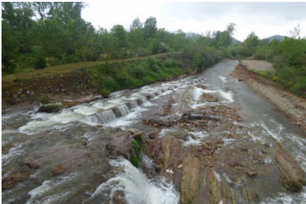
Figura 13. Escala desde el puente de la carretera CA-280. Los muros laterales no están sobredimensionados, desbordando caudal por ellos
