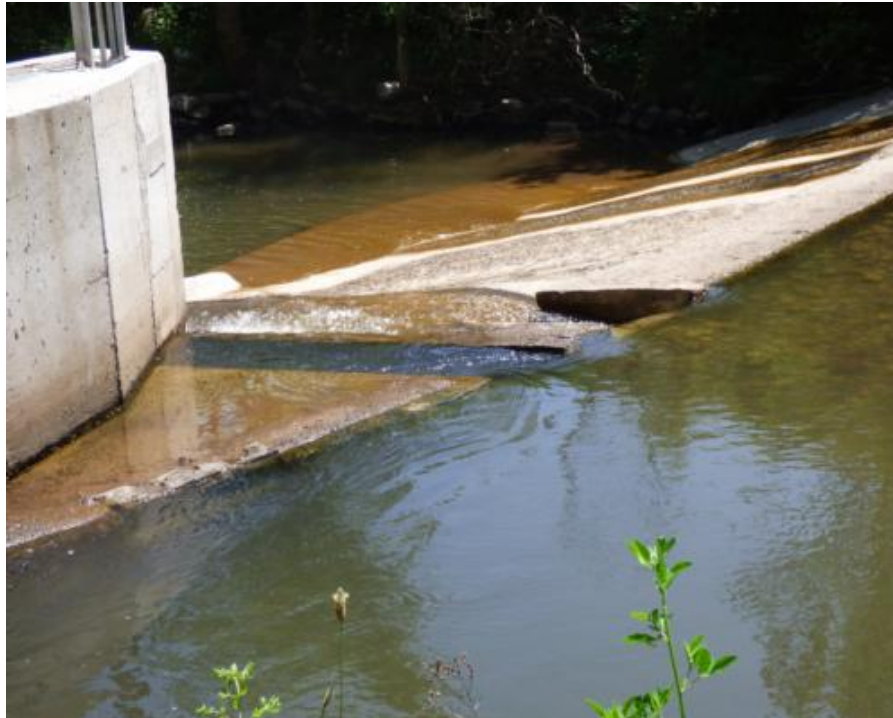
Figura 21. Canal practicado en el azud para permitir la entrada de caudal a la escala
