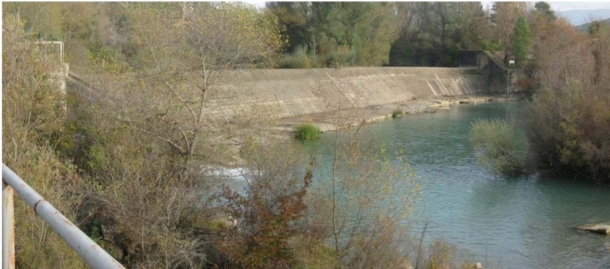
Figura 29. Vista del azud de la C.H. de Javierrelatre II. La escala de peces se emplaza en la margen derecha del azud. El emplazamiento del paso no es el correcto porque la zona donde hace embudo el río con la disposición del azud es la margen izquierda.
