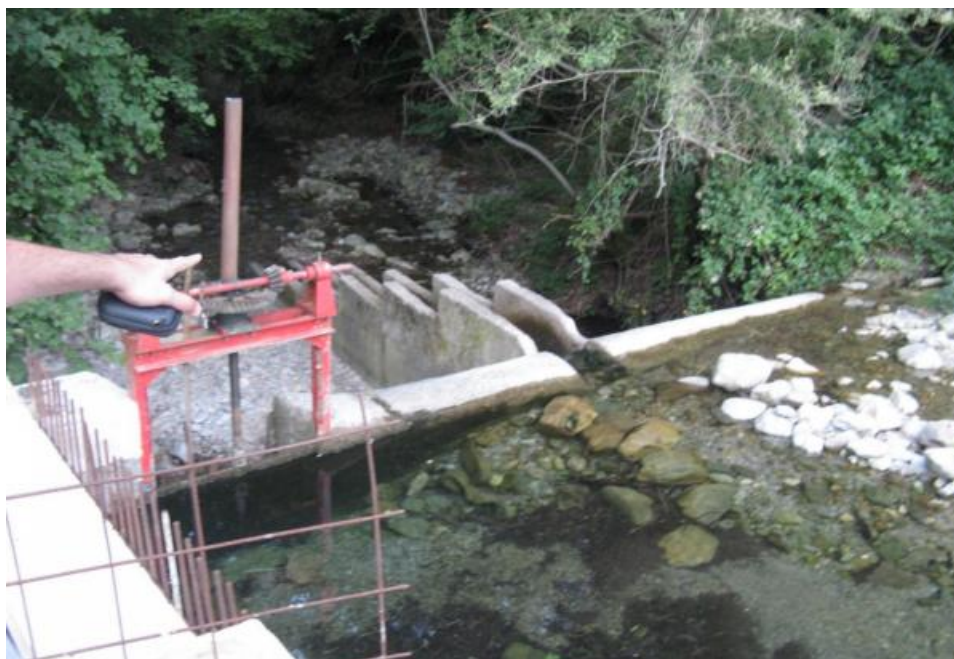
Figura 53. Vista desde aguas arriba de la entrada de caudal a la escala donde se aprecia que el azud está totalmente colmatado.
