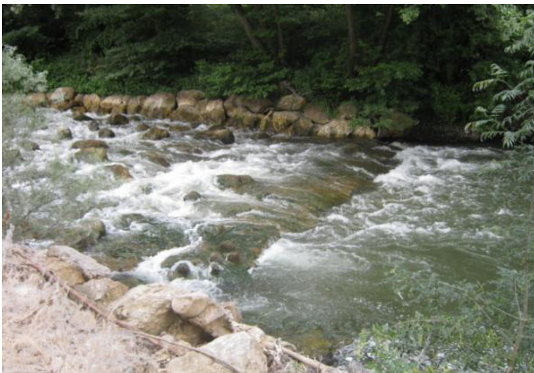
Figura 51. Detalle de la entrada al paso desde aguas abajo en el año 2015. La entrada al paso ya se encontraba ligeramente descalzada
