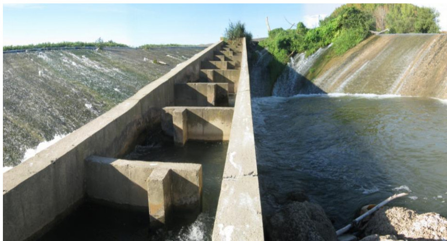
Figura 92. Escala del azud de la CH. Azagra Machín. Los deflectores de los tabiques se encuentran contruidos en sentido opuesto al flujo de corriente por lo que no son efectivos. A pesar de ello el comportamiento hidráulico en el interior de la escala es correcto, presentando potencias bajas y vertidos semisumergidos.
