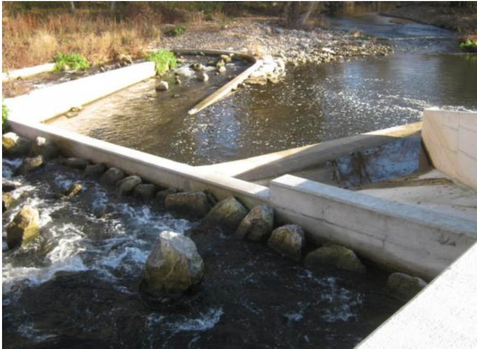
Figura 71. Entrada a la rampa para los peces en donde se aprecia que el caudal de llamada es muy bajo.
