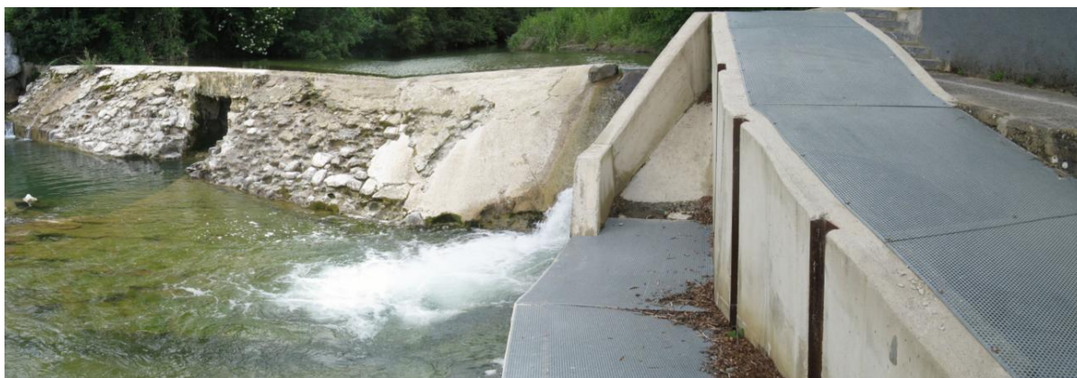
Figura 76. Caudal concentrado en la entrada del paso azud del Molino de Ochagavía. Este paso cuenta con un trames de malla pequeña lo que oscurece el interior del paso.
