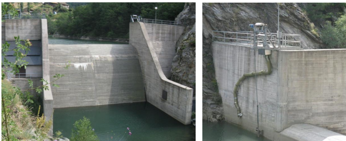
Figura 8. Azud de la CH Montenartó, con una altura mayor a los 7 m. El ascensor se localiza en la margen izquierda. En la imagen de la derecha puede apreciarse el tubo por el que descienden los peces después de haber remontado el obstáculo.
