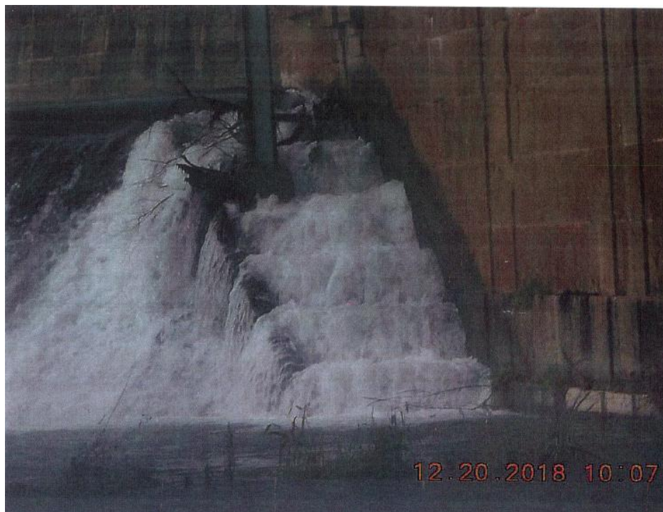
Figura 56. Vista del paso de peces en cual se encuentra totalmente desbordado. Esto se debe a que el dimensionamiento del vertedero de entrada de caudal al paso no es correcto
