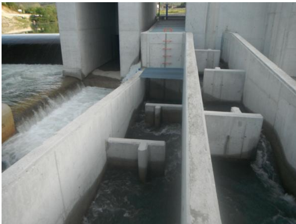
Figura 66. Vista del interior del paso de peces azud de la presa de cola de Itoiz. En la tramada de la derecha se aprecia el vertido sumergido entre artesas
