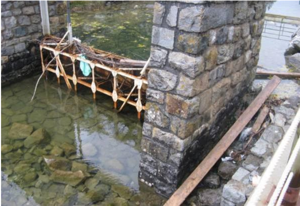
Figura 20. Vista del paso del azud del Ibón de Baños por el cual no circula caudal y se encuentra obstruido por materiales de obra. En el caso de que se retiren dichos materiales y circulara un cierto caudal podría ser permeable para peces con una elevada capacidad de remonte como la trucha común, no obstante el grado de funcionamiento que presenta es muy bajo.
