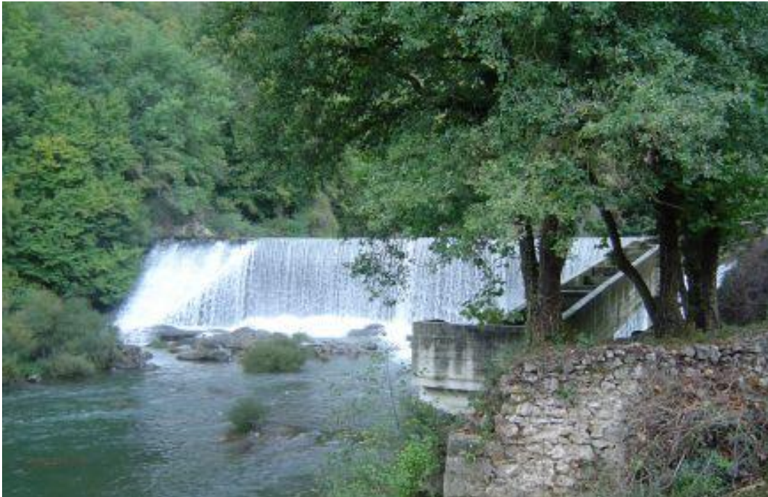
Figura 18. Azud de la CH de Larraun o Ferrería y escala de artesas localizada en la margen izquierda.
