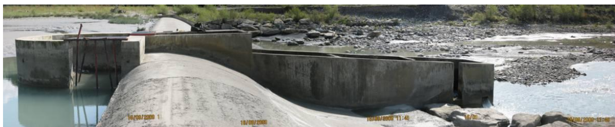
Figura 17. Vista de la escala de peces de la toma de Graus. A la izquierda de la fotografía se aprecia la entrada de caudal al paso la cual está sobre dimensionada, provocando que los caudales circulantes y la energía en el interior de las artesas sean muy elevados. Como puede apreciarse en el costado derecho de la fotografía, la entrada del paso queda descolgada de la lámina del río y además no existe ningún caudal de llamada que atraiga los peces a la entrada del paso.
