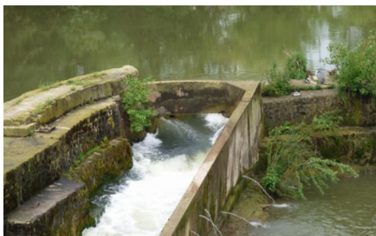
Figura 13. Entrada de caudal al paso mal dimensionada, permite la entrada de un caudal mayor que el diseñado para las artesas tipo.
