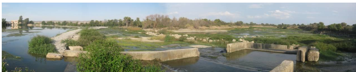
Figura 89. Azud de la CH de Pina y de la escala de peces de la margen derecha que se encuentra parcialmente destruida.
