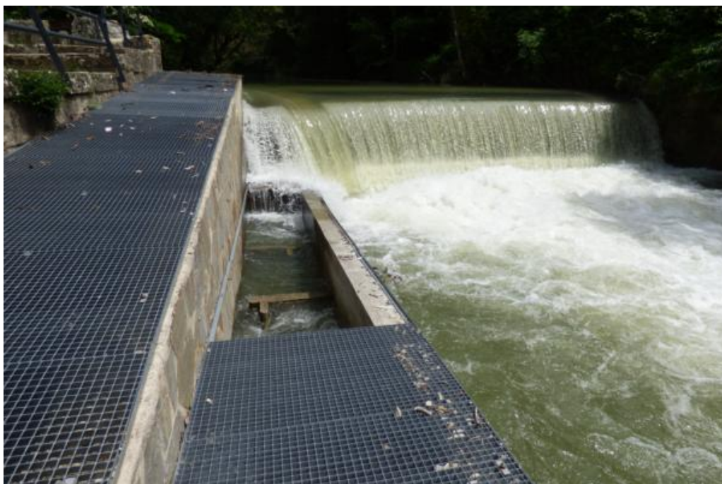
Figura 37. De la parte baja de la escala en la que se aprecia que el elevado caudal del río y el desbordamiento del muro exterior ha incrementado el nivel del agua en el interior de la escala rebasando el tabique interior.
