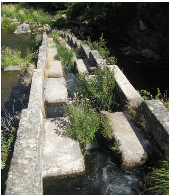
Figura 36. Vista de los estanques de la CH de Las Cuevas. Las artesas son de reducido tamaño y se encuentran comunicadas mediante vertederos que funcionan como lámina libre, por lo cual el pez se ve obligado a tener que saltar para ascender hasta la siguiente artesa.
