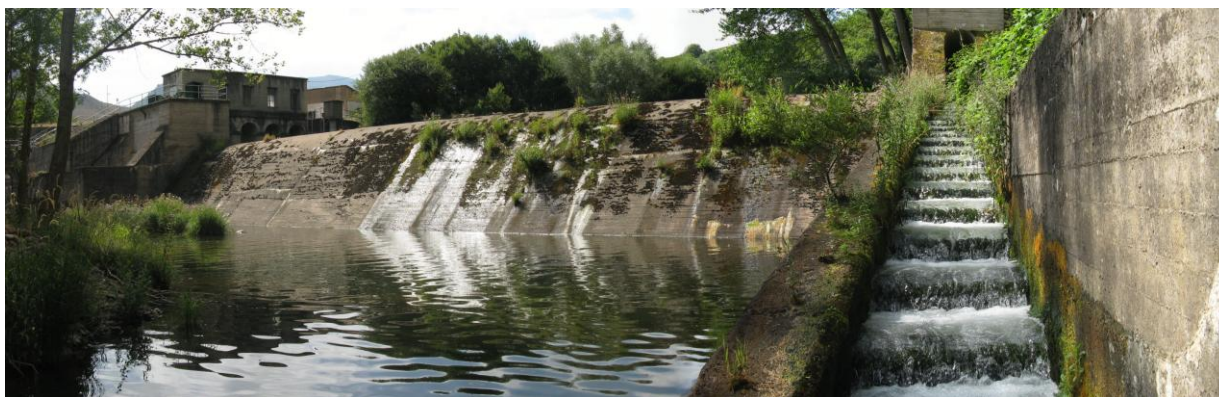
Figura 40. Azud de derivación del Canal de la Margen Izquierda del Najerilla. La escala se encuentra emplazada en la margen izquierda del obstáculo, la cual presenta artesas de dimensiones reducidas y escaso calado. El escaso caudal unido a una entrada alejada de la base del azud hace que su efecto llamada sea bajo
