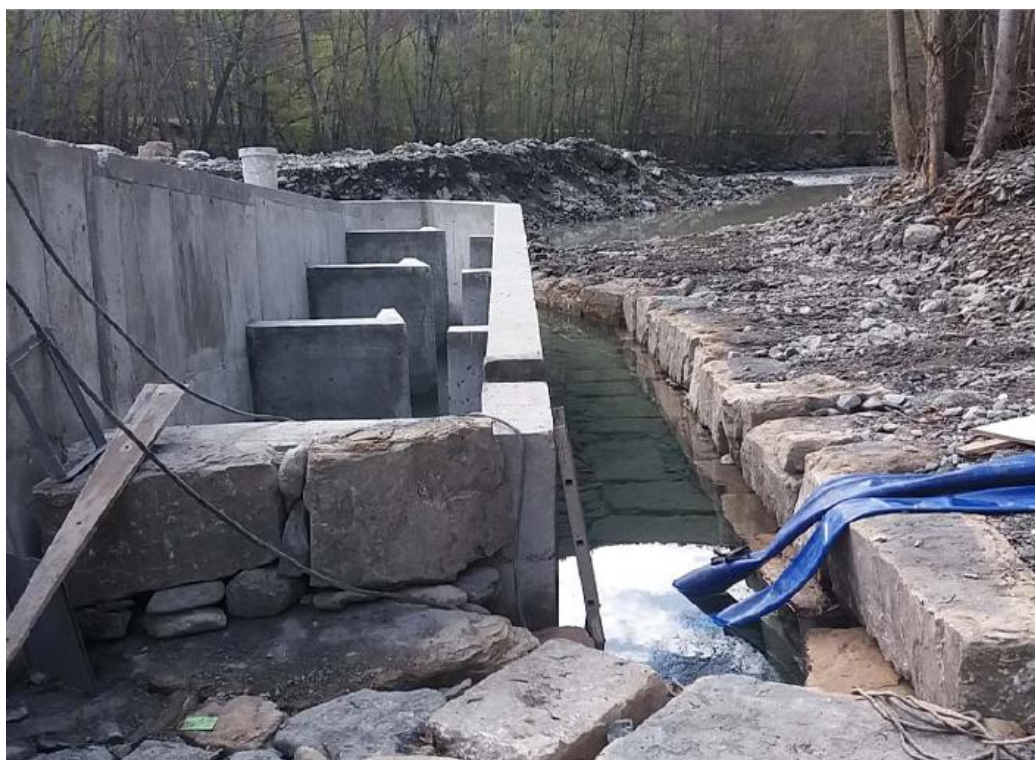
Figura 18. Canal de transición del cauce del río a la poza de entrada al paso de peces
