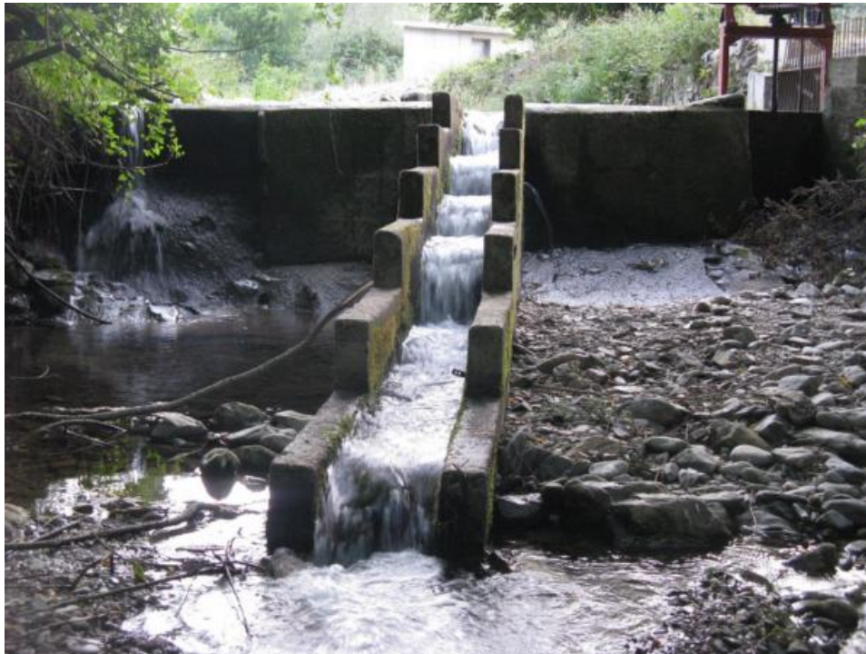
Figura 52. Azud y el paso de peces de la CH de Lugar del Río. Se trata de una escala de artesas de dimensiones reducidas; los saltos y el escaso calado hacen que sea impermeable para la mayor parte de los peces.
