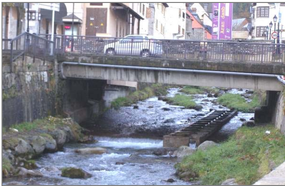
Escala de peces bajo el puente de Carrer Sarriulera en Vielha
