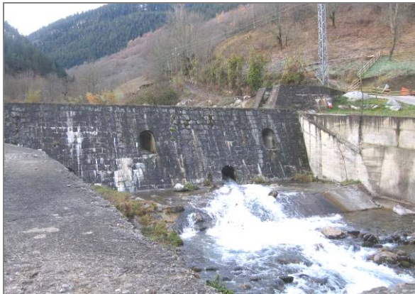
Río Nere en su entrada en Vielha, presa para el control de avenidas
