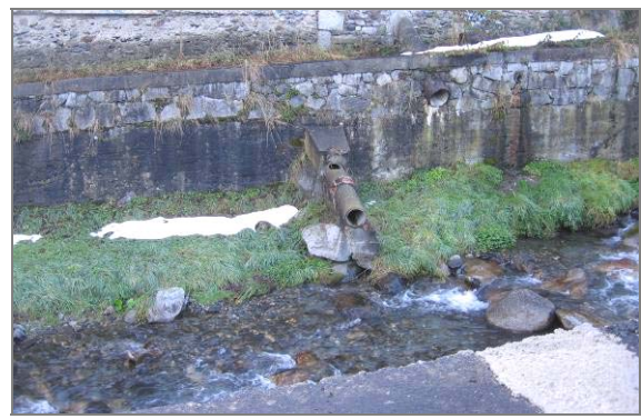
Vieja tubería de desaguen en la margen derecha del río Nere en Vielha
