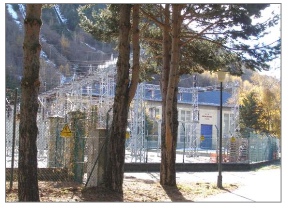
Central hidroeléctrica de Arties
