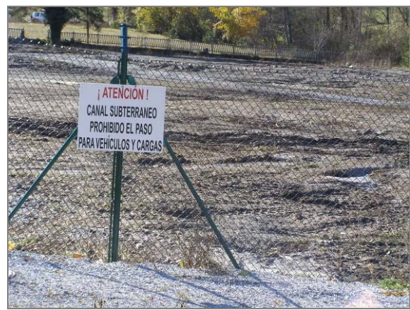
Panel informativo de la obras de cubrimiento del canal de la CH de Vielha como espacio publico
