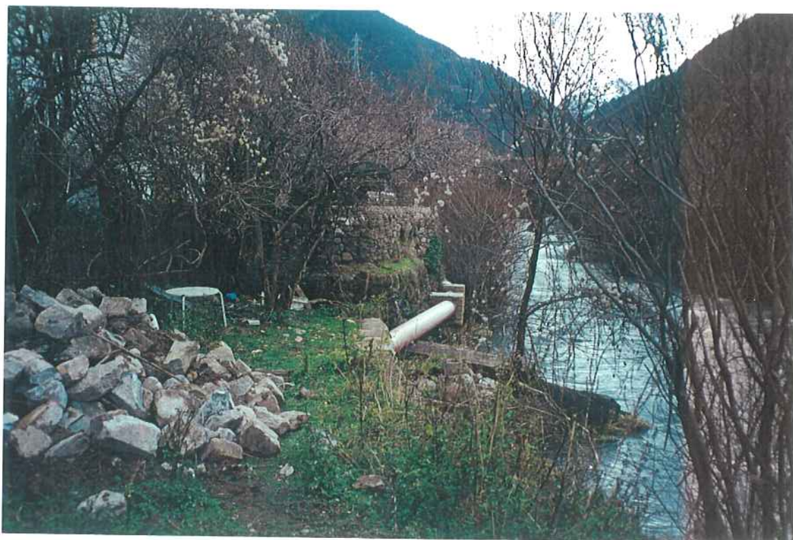
TUBERÍA EN P-29
