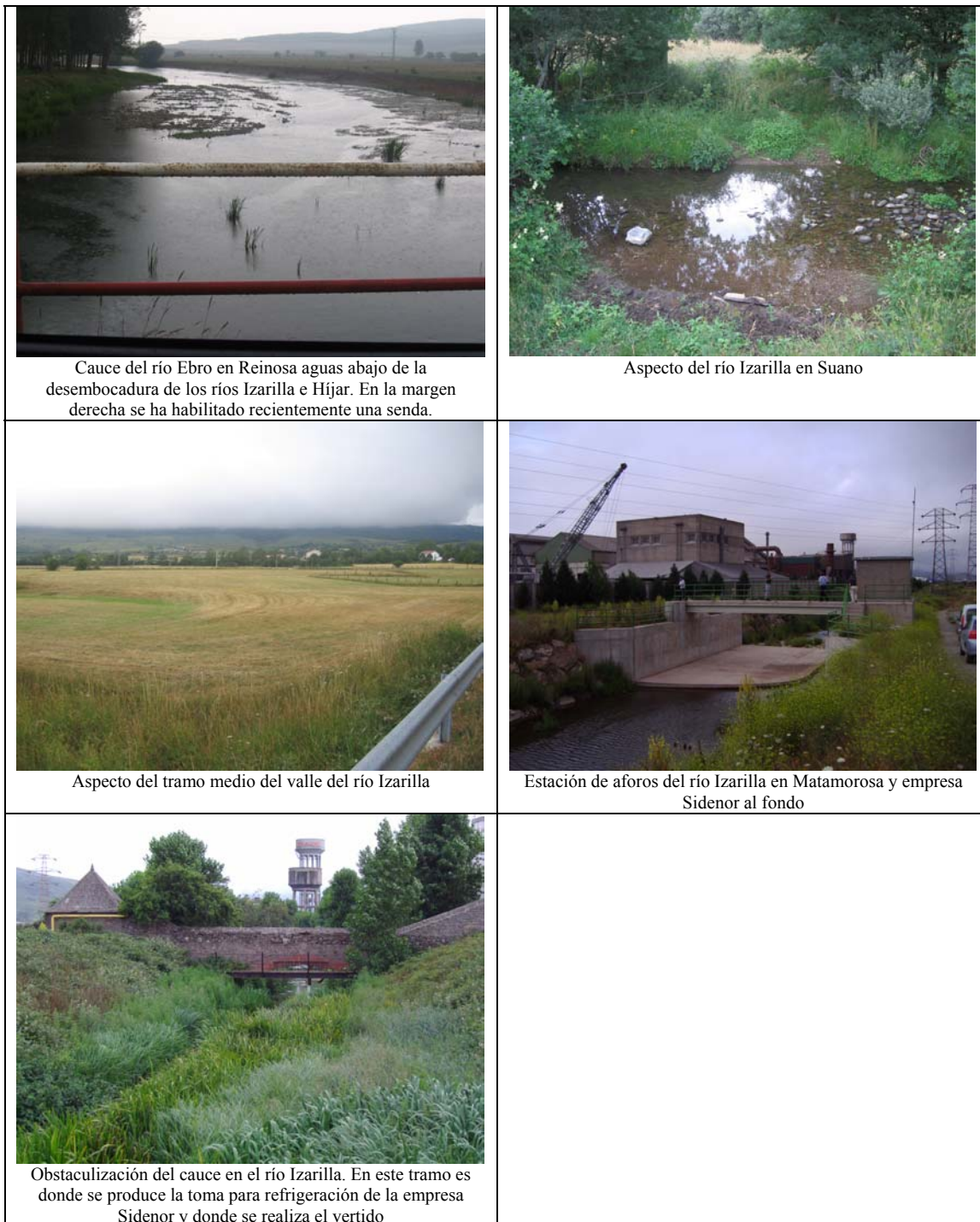
Figura 39 (continuación): Fotos representativas de las características y problemas del río Ebro desde Fontibre hasta el embalse y del río Izarilla.
