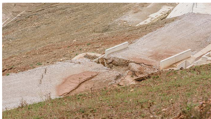
Detalle de grietas junto a la obra de fábrica para evacuar la escorrentía superficial.
