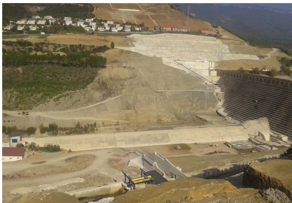
Vista panorámica del deslizamiento encuadrado en las obras de excavación del cimiento de la nueva presa en construcción.
