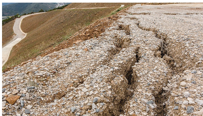
Detalle de las grietas de la berma número 5.
